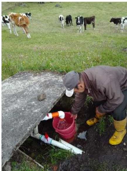
Figura N° 14. Capacitación operativa en regulación de caudal de entrada al tanque de almacenamiento
