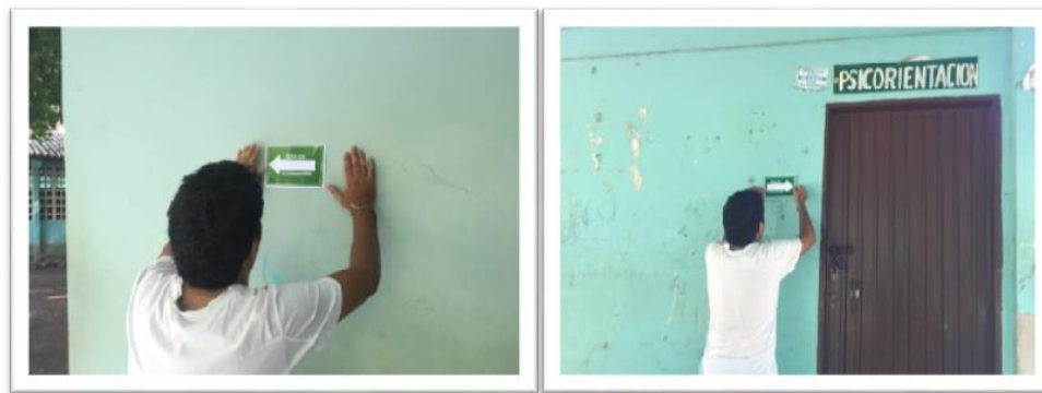
Figura 29 Señalización (Salida de emergencia / Plan de evacuación).
