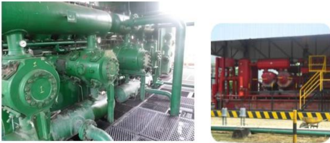
Figura 12 Operación y mantenimiento
