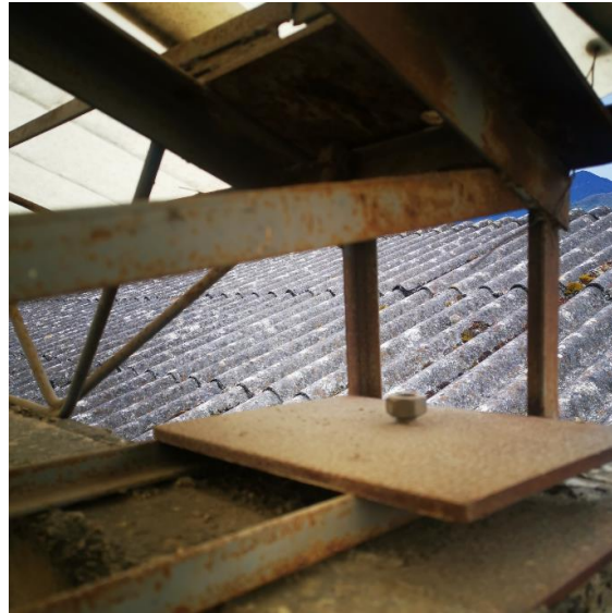
Fotografía 4. Inicio de proceso de corrosión en estructura metálica. Fuente: Propia
