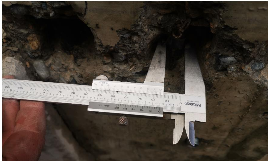
Fotografía 26. Medición diámetro refuerzo vertical intermedio – Columna 3
