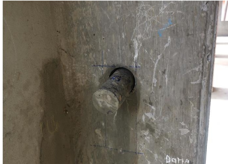
Fotografía 18. Extracción de núcleos, detalle de núcleo – Columna 1 (cara lateral)
