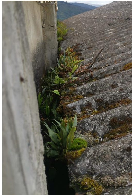
Fotografía 3. Cunetas obstruidas. Fuente: Propia
