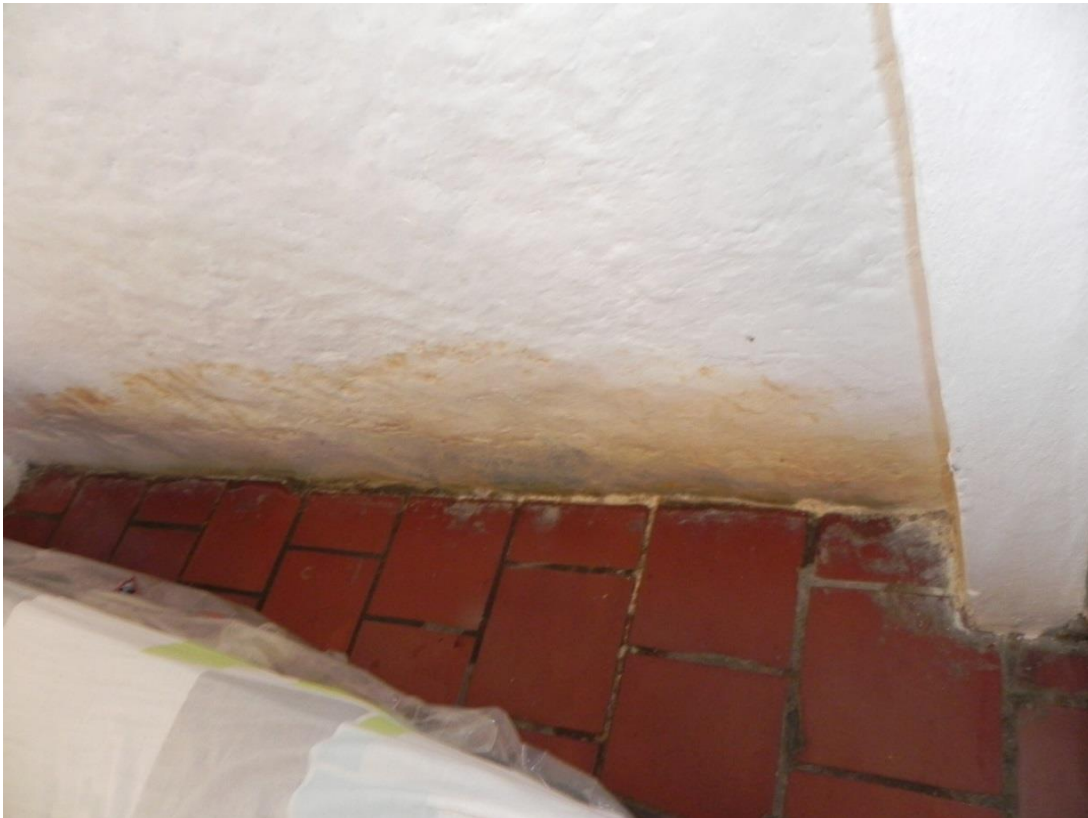
Figura 101. Muro en tapia con humedad proveniente del suelo. Adaptada de "Archivo", archivo autor, 2014
