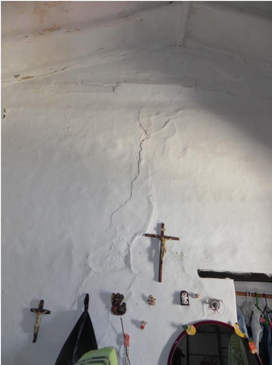
Figura 103. Grieta diagonal en muro. Adaptada de "Archivo", archivo autor, 2014
