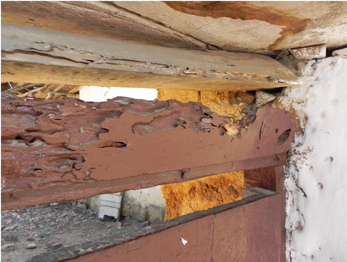
Figura 110. Dintel y puerta afectada por comején. Adaptada de "Archivo", archivo autor, 2015
