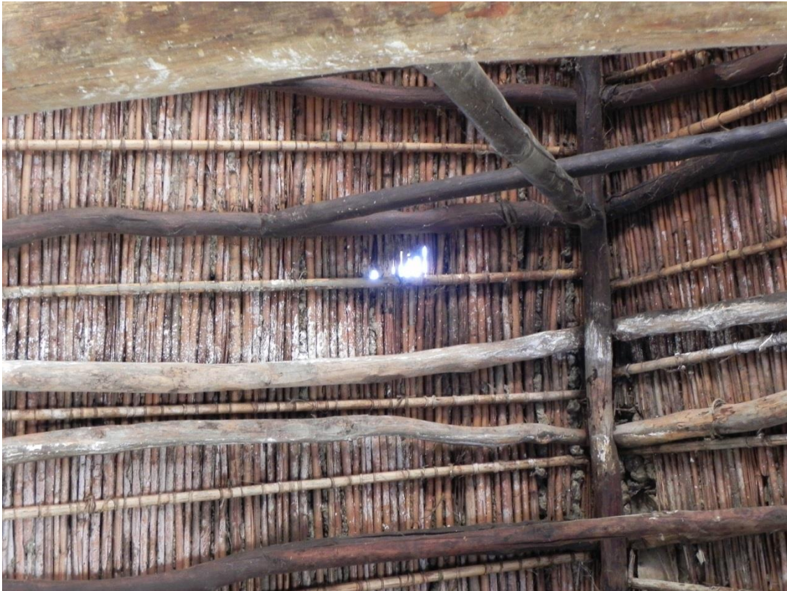
Figura 112. Orificio cubierta por deterioro de mortero y esterilla en caña. Adaptada de "Archivo", archivo autor, 2015
