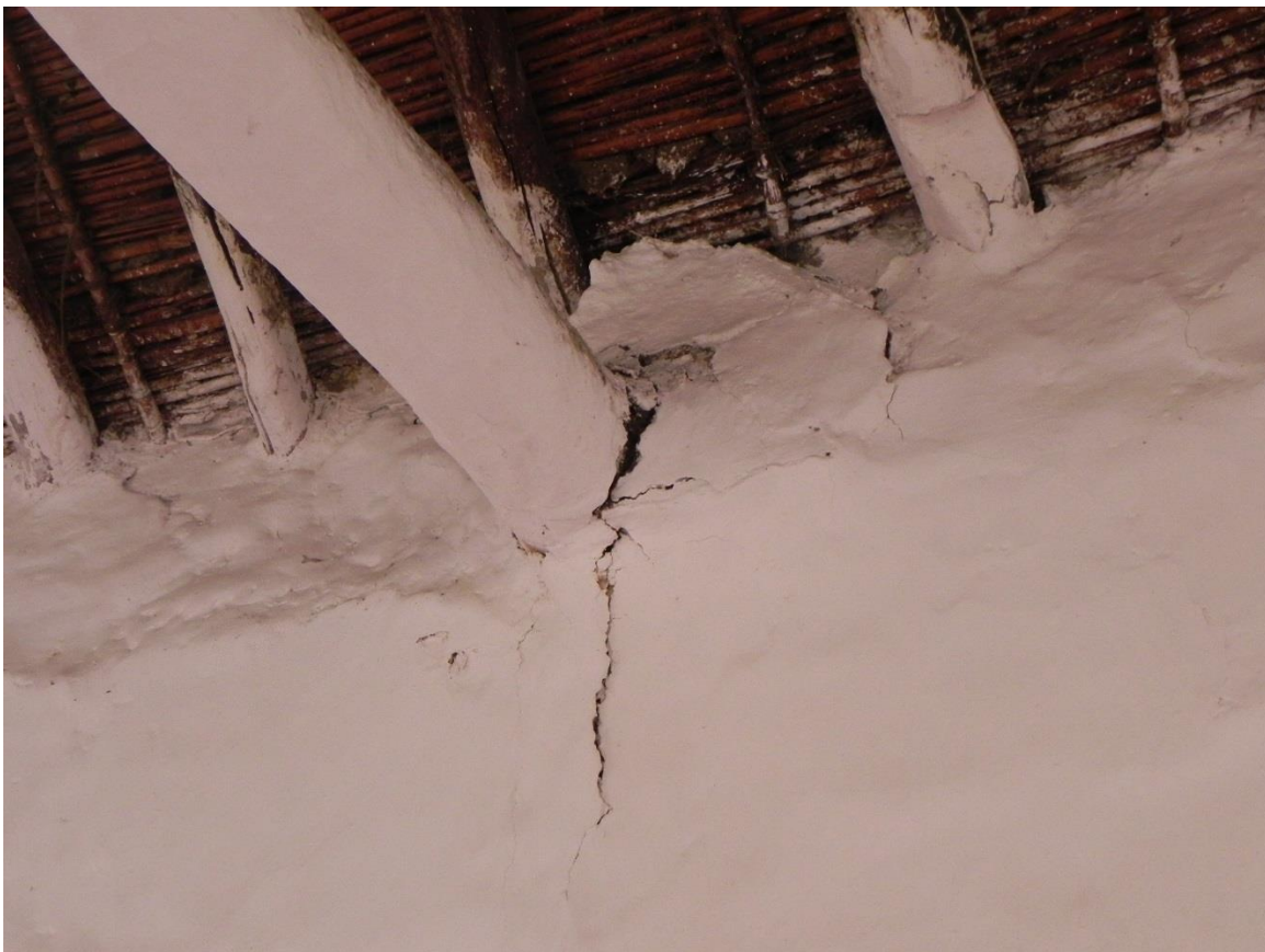
Figura 102. Grieta vertical debido a fallas en viga tirante. Adaptada de "Archivo", archivo autor, 2014
