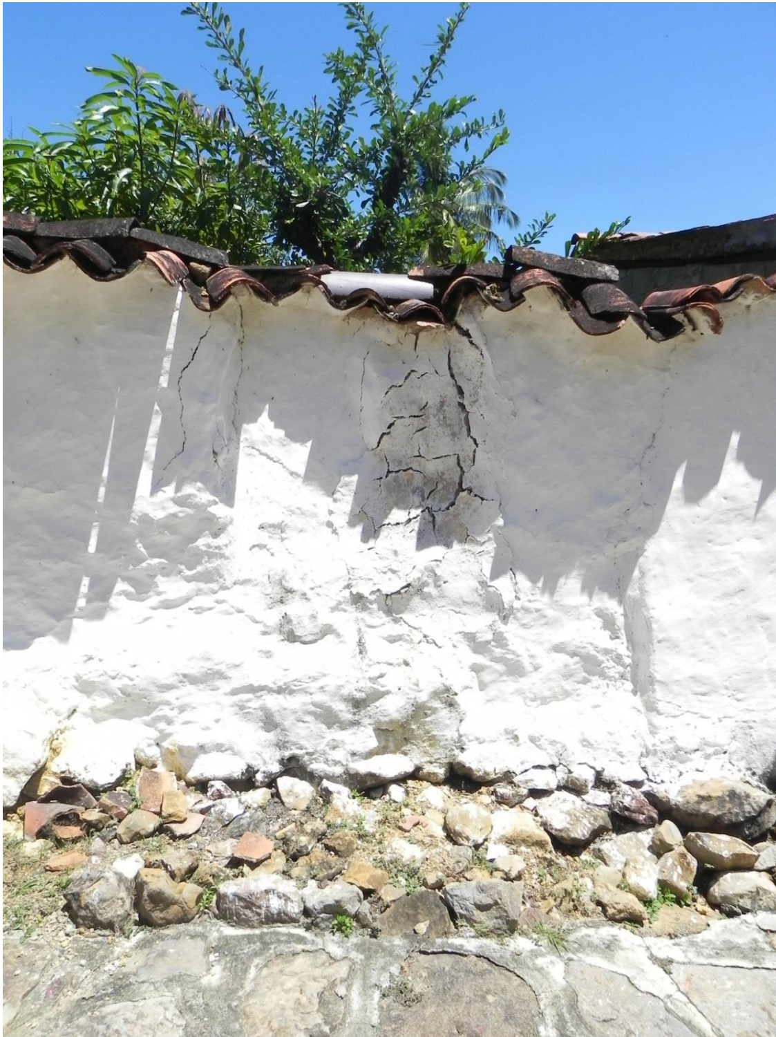
Figura 100. Cimentación sin pañete de protección. Adaptada de "Archivo", archivo autor, 2014
