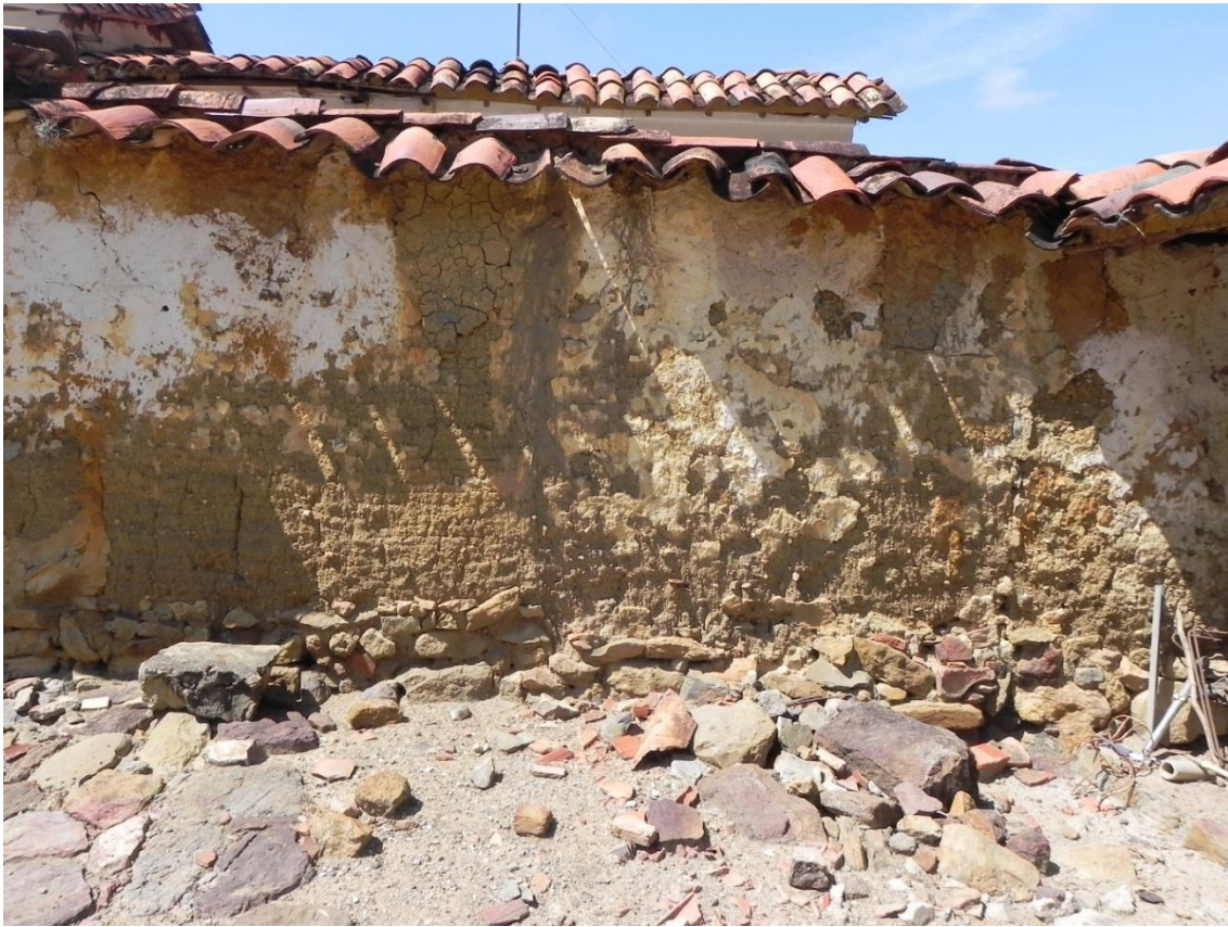
Figura 113. Acabado muro deteriorado. Adaptada de "Archivo", archivo autor, 2015
