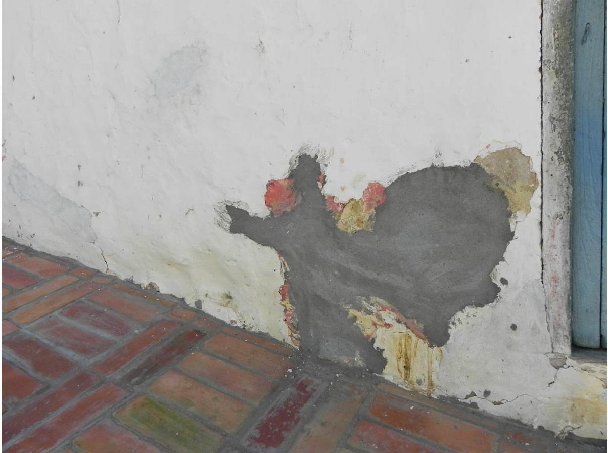
Figura 104. Restauración indebida en muro de tapia. Adaptada de "Archivo", archivo autor, 2014
