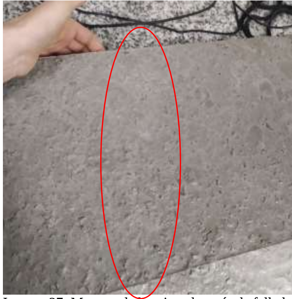
Imagen 27: Muestra de la grieta después de fallada.
