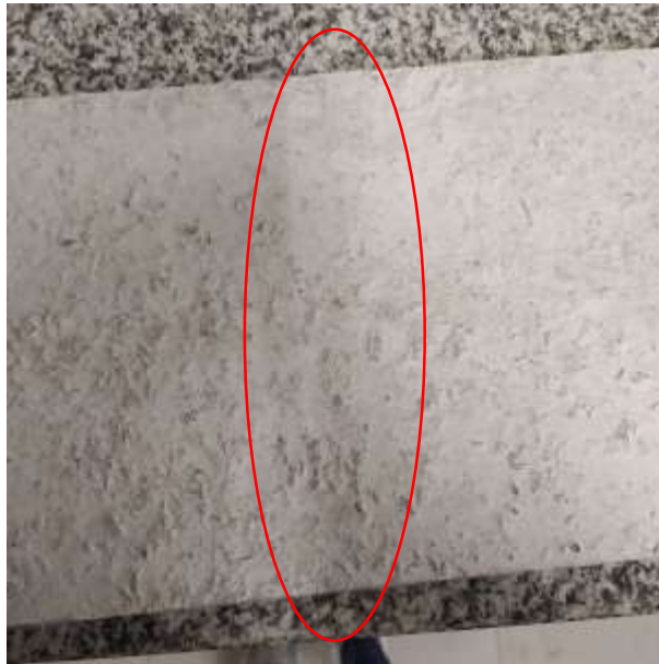
Imagen 23: Aparición de grieta después de fallada.
