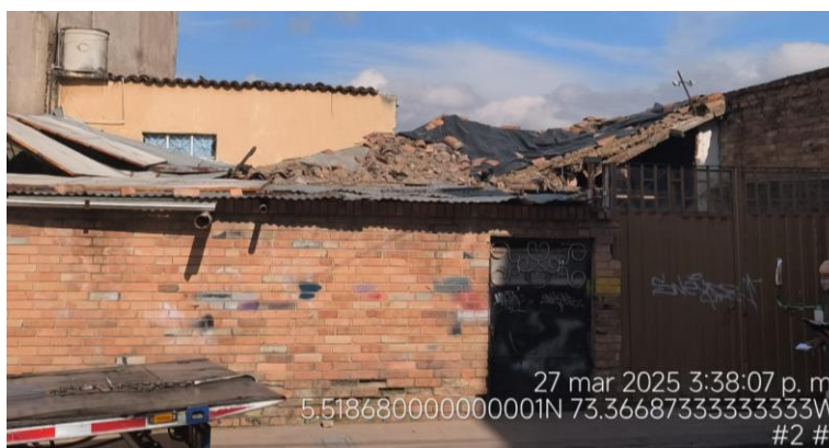
Figura 28. Estado de cubierta con riesgo de caída.
