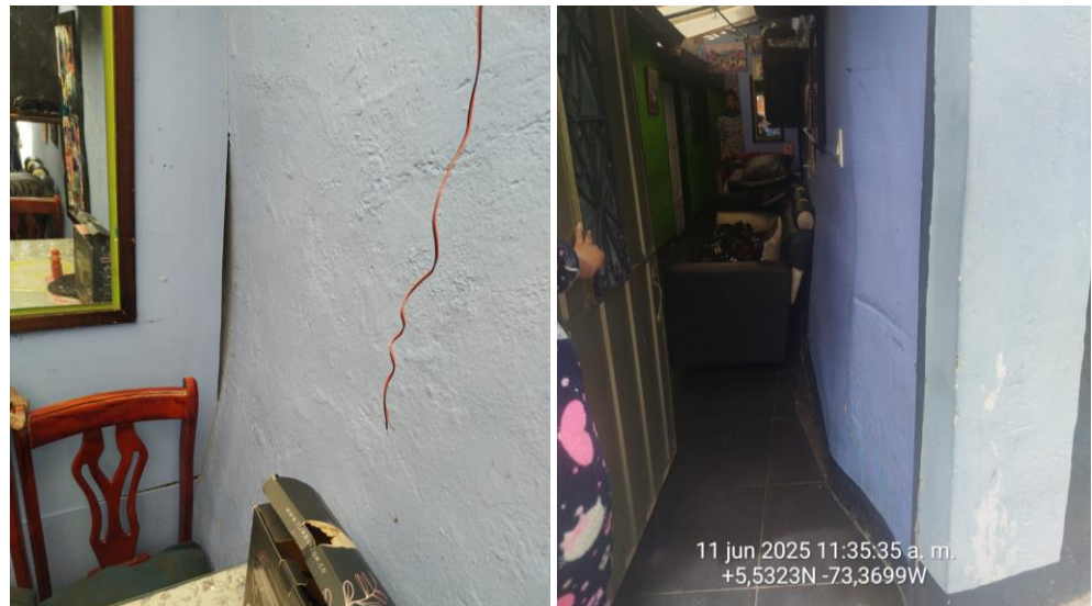
Figura 36. Muro con deformación.
