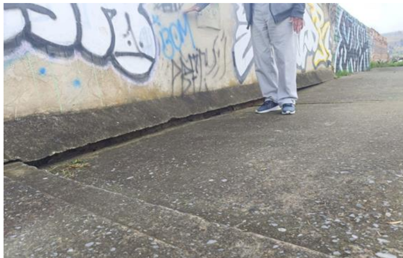
Figura 33. Hundimiento de placa del sendero.
