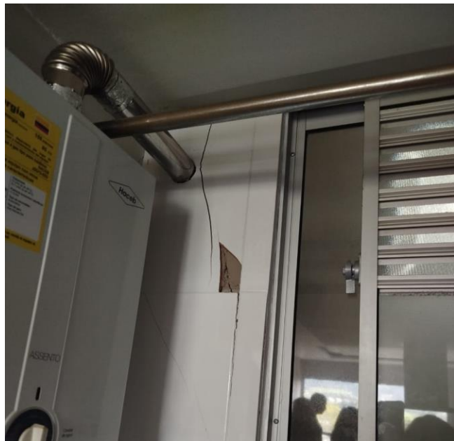
Figura 39. Fisuras en núcleo vista interna.
