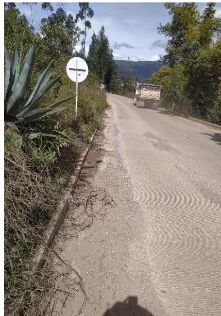
Ilustración 11 Sedimentos en las cunetas de la vía.
