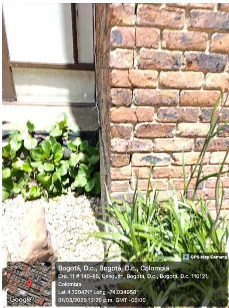
Ilustración 23. Fisuración muros no estructurales Archivo: Fuente propia
