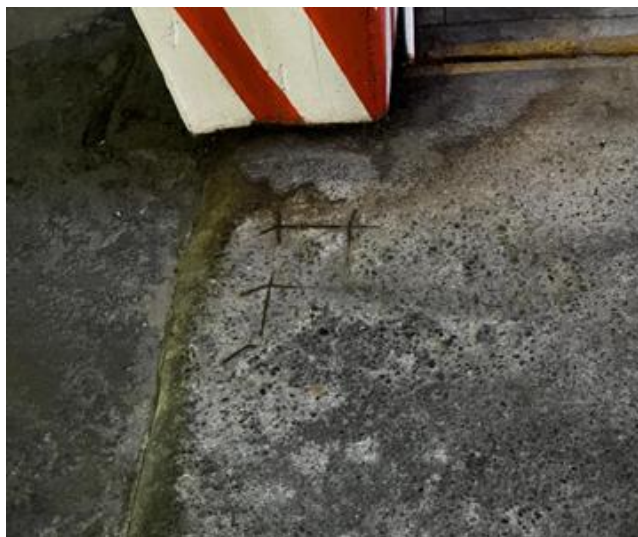
Ilustración 19. Desprendimiento de material y exposición de acero 1 Archivo: Fuente propia
