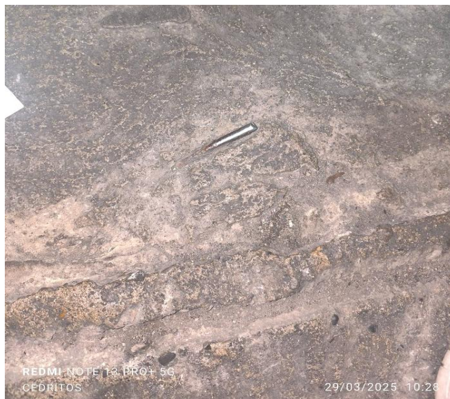
Ilustración 20. Desprendimiento de material y exposición de acero 2 Archivo: Fuente propia
