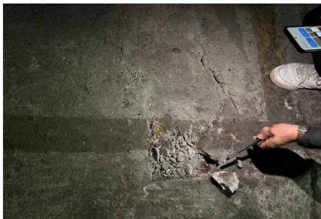
Ilustración 16. Desprendimientos de material estructural 1 Archivo: Fuente propia
