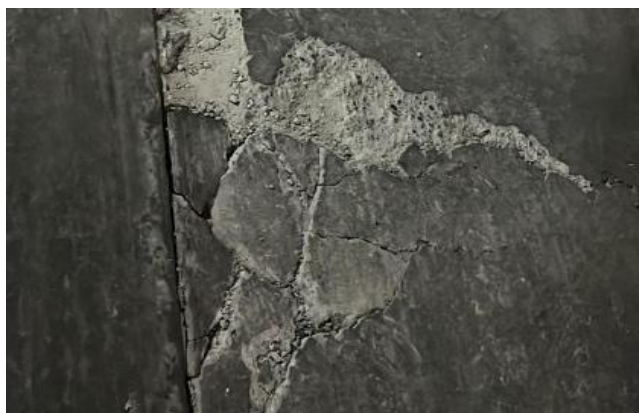
Ilustración 18. Desprendimientos de material estructural 2 Archivo: Fuente propia
