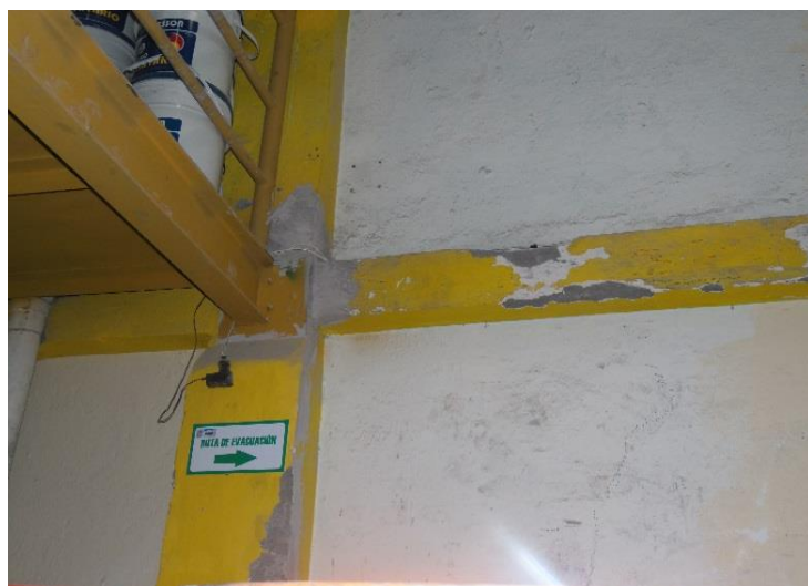
Ilustración 11 Daño en elementos estructurales por golpes y maniobras indebidas en el uso del inmueble Eje 1 8 (Fuente. Los Autores)
