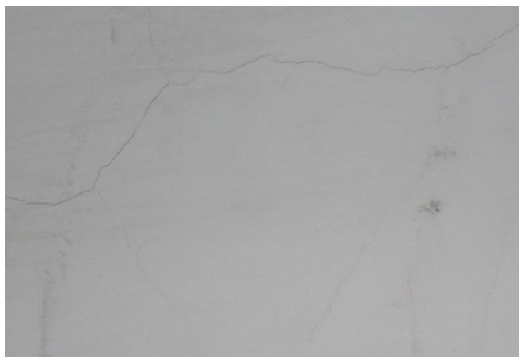
Ilustración 12 Fisura sobre muro a nivel del segundo piso Eje 5 D-E (Fuente. Los Autores)
