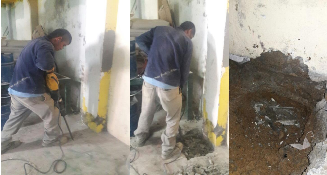
Ilustración 35 Auscultamiento base de la columna más afectada (Fuente. Los Autores)
