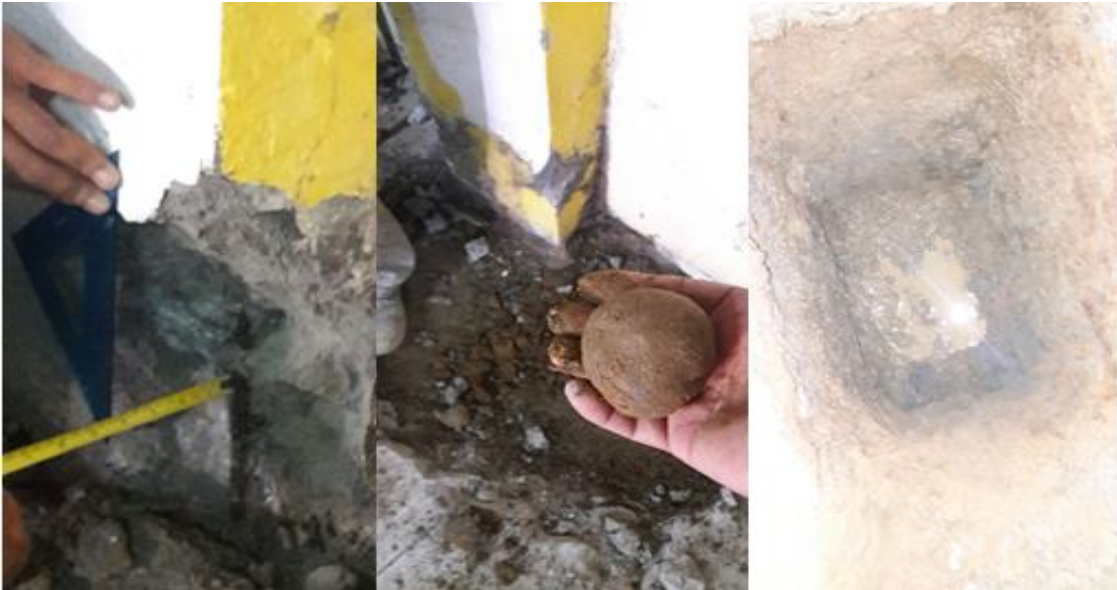
Ilustración 36 Muestras de estado de excavación en lesión más importante (Fuente. Los Autores)
