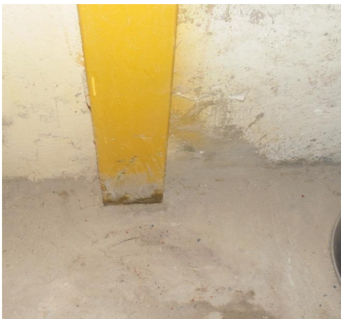
Ilustración 7 Corrosión por posible humedad sobre estructura de acero en el primer nivel Eje 1 (Fuente. Los Autores)
