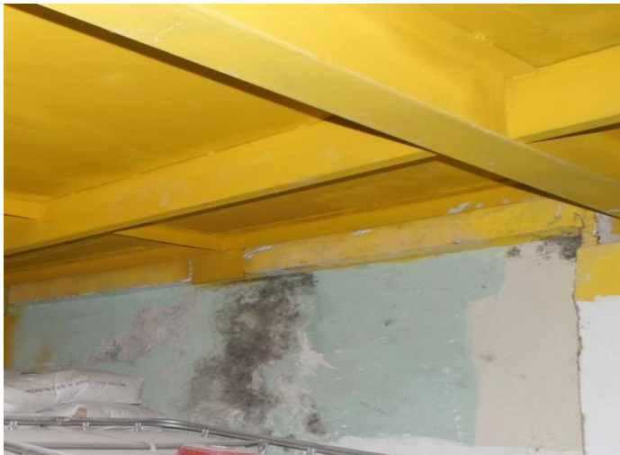
Ilustración 8 Presencia de Humedad sobre pared costado sur eje (A-2-5) (Fuente. Los Autores)
