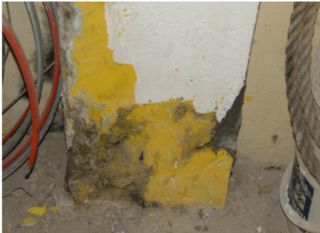
Ilustración 6 Humedad en base de columna primer piso A2 (Presencia de carbonatación) (Fuente. Los Autores)
