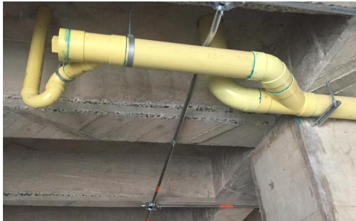
Imagen 26. Puntos de lavamanos y sifones de la red de aguas negras y red de iluminación en piso 1
