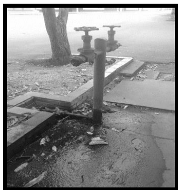
Figura 3: Llave contra incendios.
