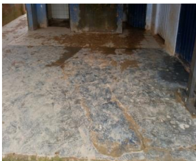
Estado Pisos Baterías Sanitarias
