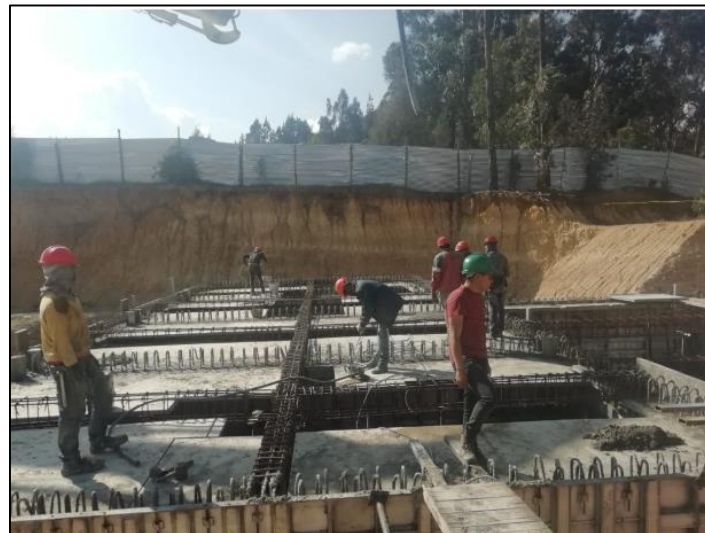
Figura 31. Tanque de Almacenamiento Proceso de Vaciado
