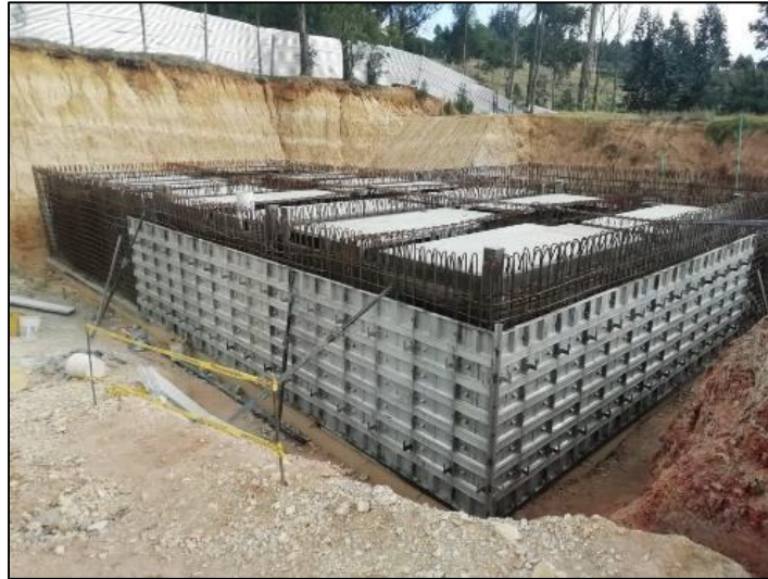
Figura 28. Tanque de Almacenamiento Armado de Aceros
