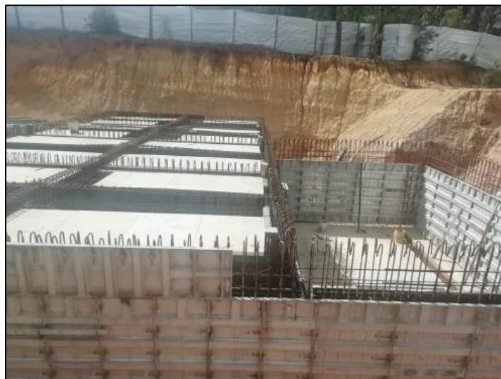
Figura 29. Tanque de Almacenamiento Formaletas
