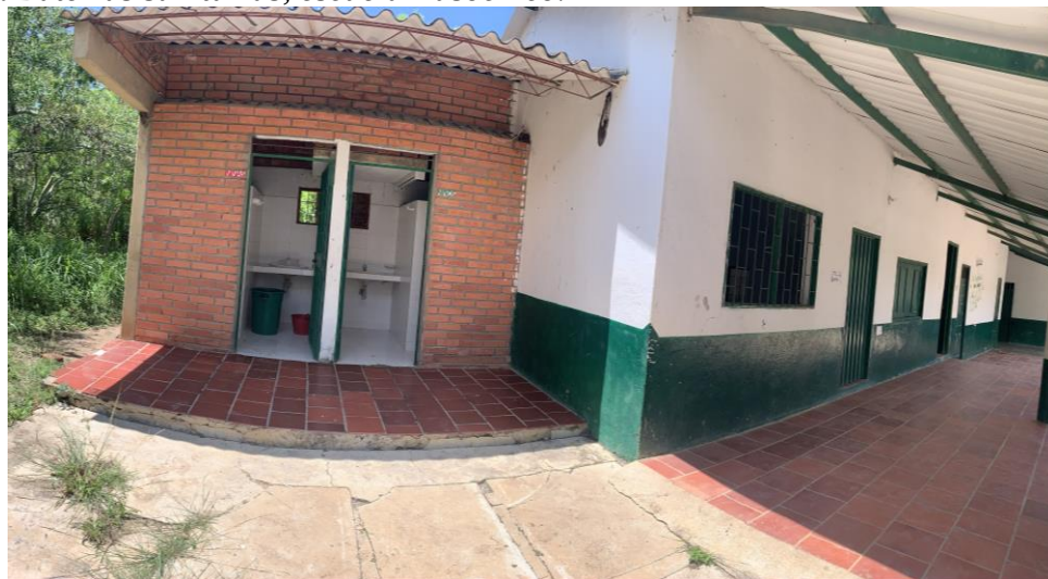
Figura 30. Baterías sanitarias, escuela Pasochico.
