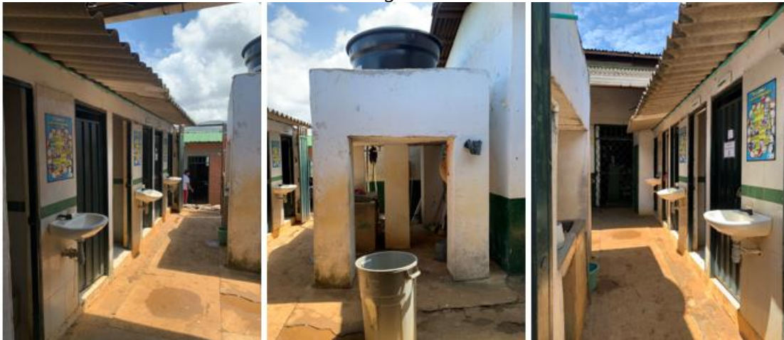
Figura 16. Unidades sanitarias de la I.E La Laguna.
