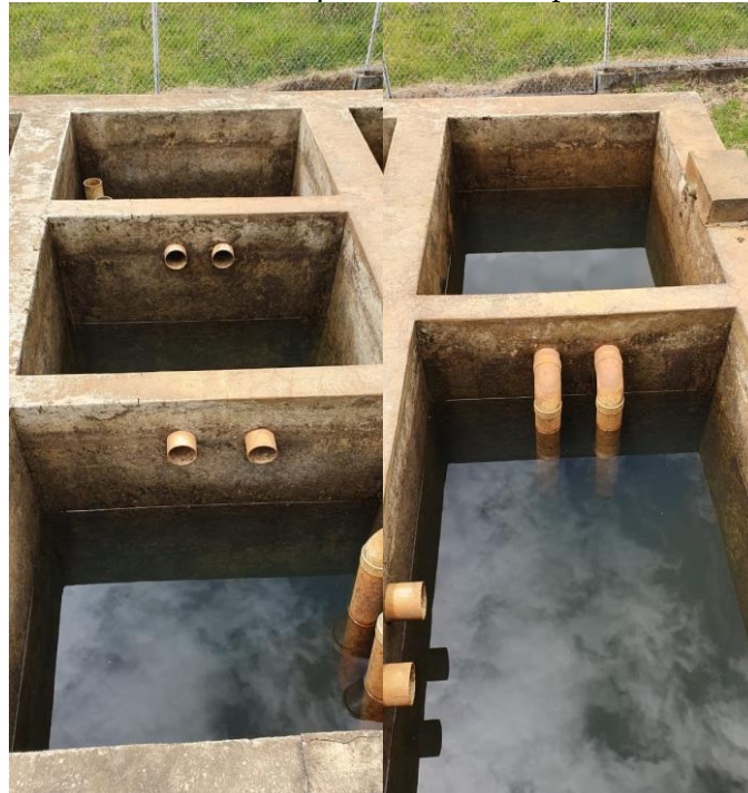
Figura 15. Estado actual del floculador de la planta de tratamiento
