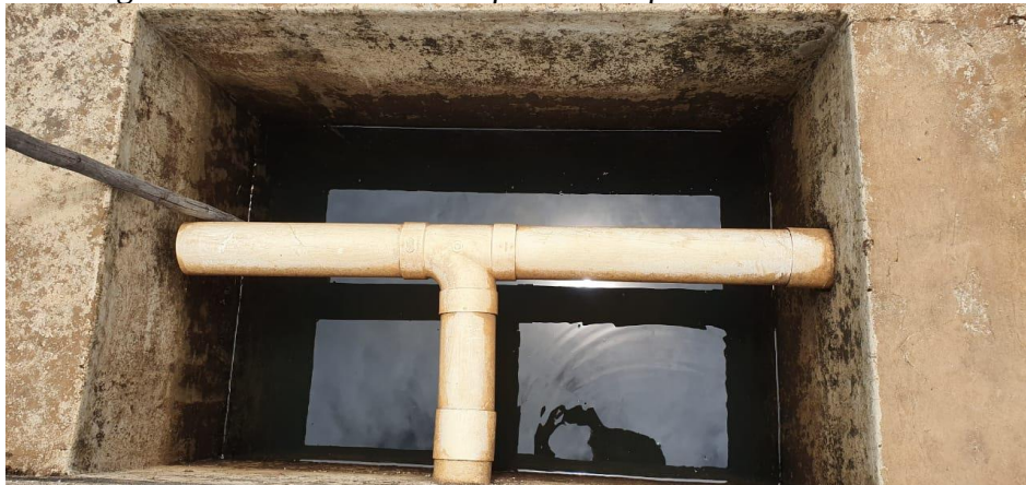
Figura 17. Estado actual del filtro de la planta de tratamiento
