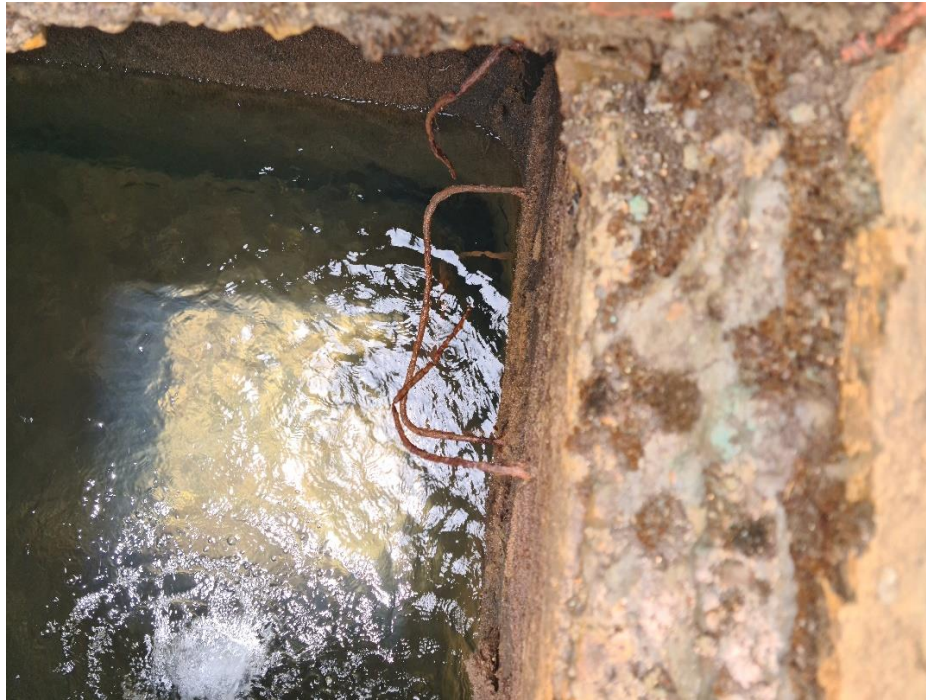
Figura 22. Patologías parte interna del tanque
