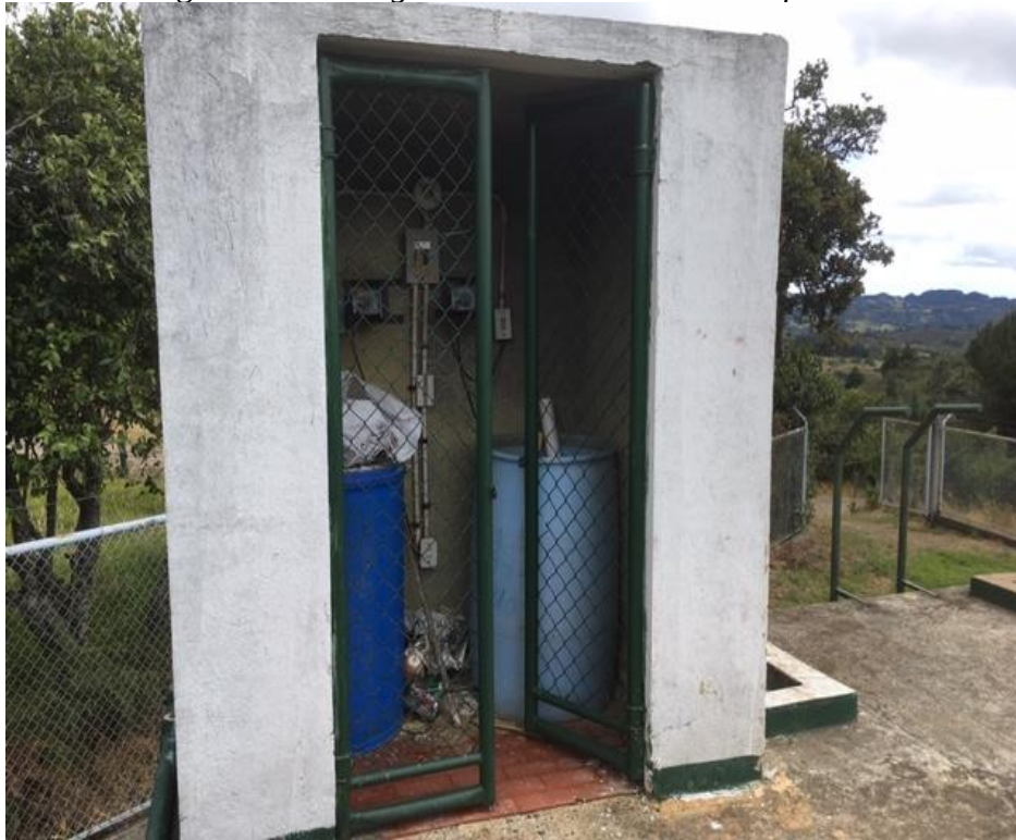
Figura 21. Patología de la estructura del dosificador
