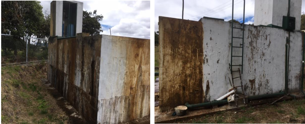
Figura 20. Patología de la estructura de los procesos
