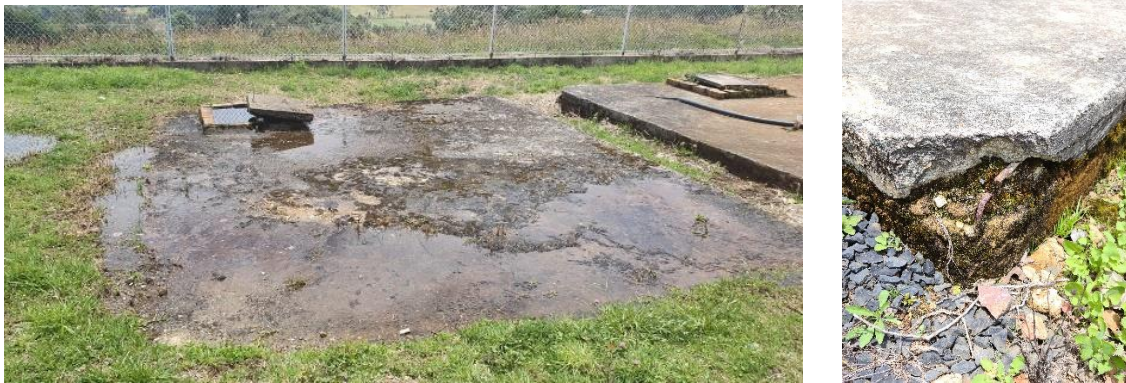
Figura 23. patologías del tanque de almacenamiento
