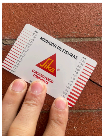
Ilustración 13. Medición de fisuras y grietas.
