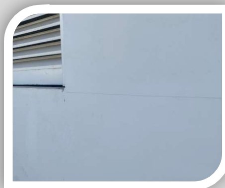
Ilustración 11.- Fisura en pie de ventana lesión 2
