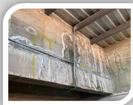
Ilustración 26.- Lesión de eflorescencia 5.2
