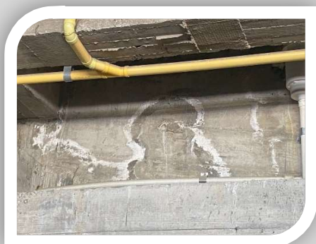
Ilustración 25.- Lesión de eflorescencia 5.1
