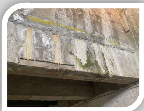
Ilustración 34.- lesión 7 química por presencia de agentes químicos.
