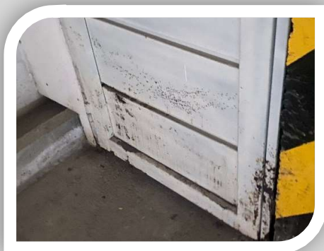
Ilustración 16.- Corrosión puerta cuarto de medición lesión 3
