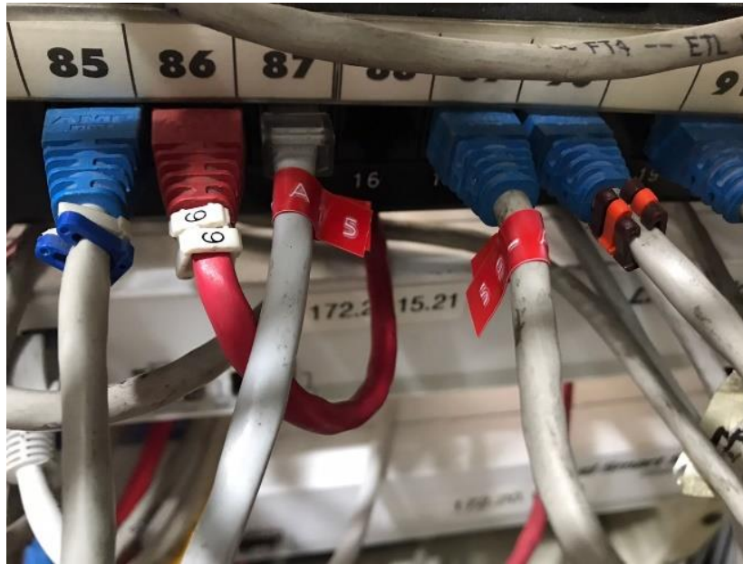
Figura 33. Rotulado del cableado UTP.
