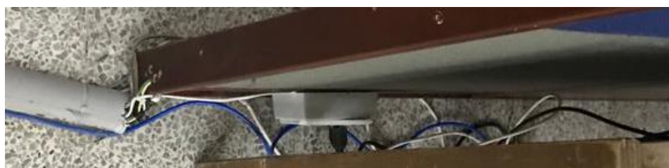
Figura 24. Cableado que no cumple las normatividades.
