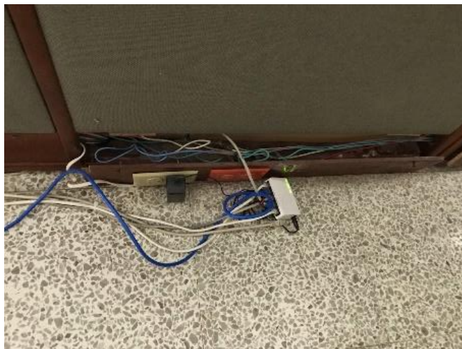
Figura 39. Cableado de red y de energía de la SEB.
