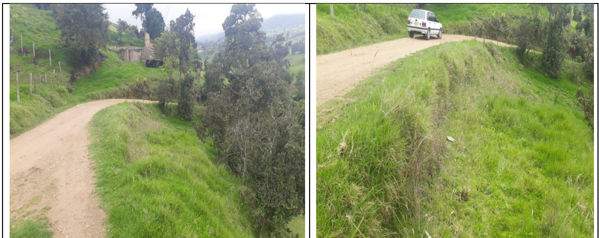
Ilustración 19.Registro fotográfico afectación en vía terciaria.
