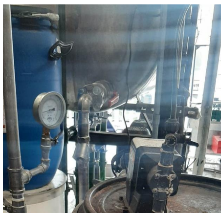
Fotografía 9. Punto 1 - Tanque de alimentación
