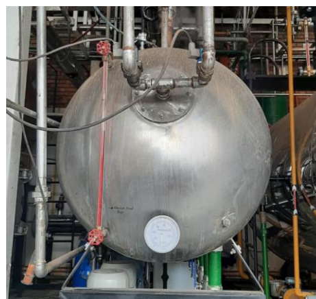
Fotografía 10. Punto 2 - Tanque de alimentación.
