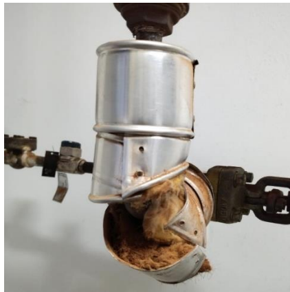
Fotografía 7. Alteración al aislamiento térmico
