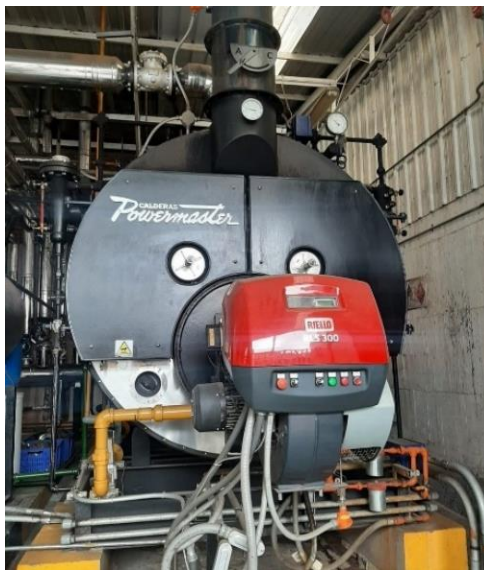
Fotografía 6. Caldera PowerMaster 200 BHP Planta Casa Luker S.A
