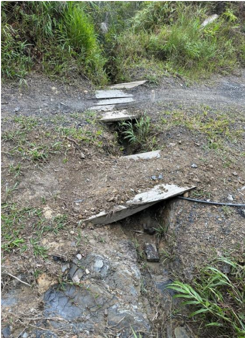
Figura 9. Evidencia de canaleta en mal estado
