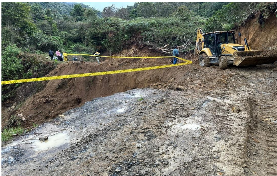
Figura 8. Mejoramiento de vía en donde se presentó un deslizamiento
