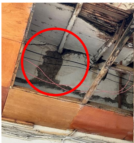
Figura 55: Manchas con presencia de líquenes, musgos y hongos o fungi en varios sectores de la cara superior de la mampostería de tapia pisada
