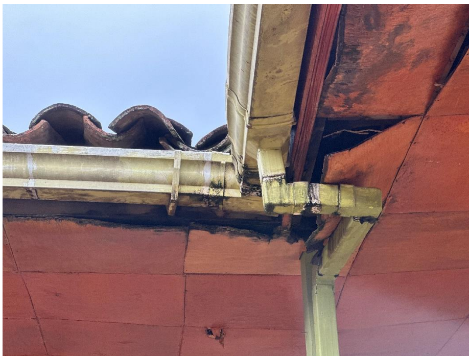
Figura 57: Corrosión y oxidación de las canoas metálicas y bajantes en el perímetro de la cubierta del patio central
