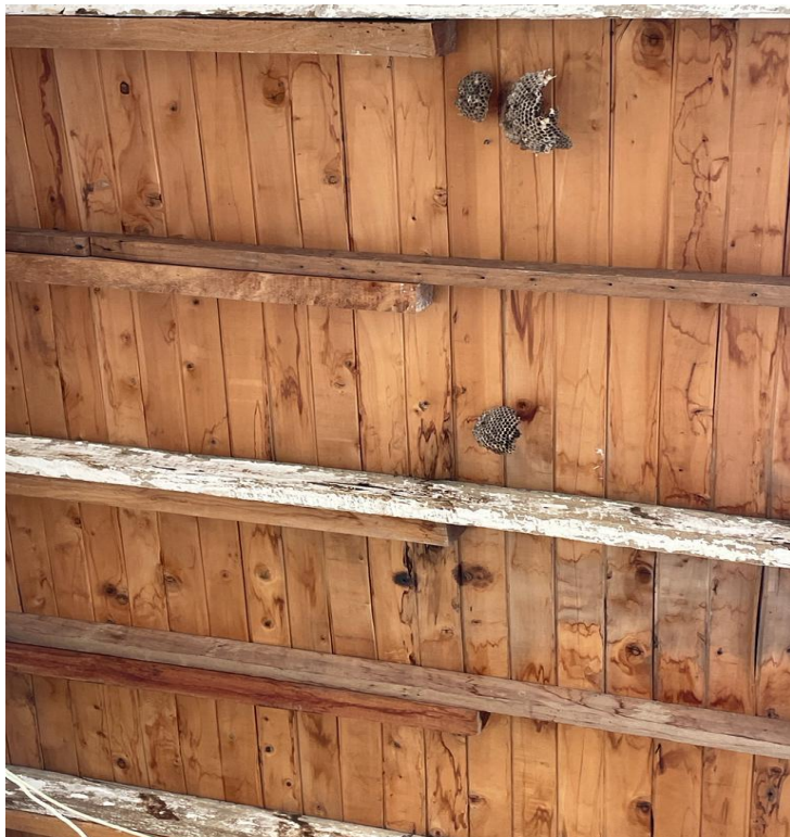
Figura 36: Detalle traslapes irregulares de alfaridas
