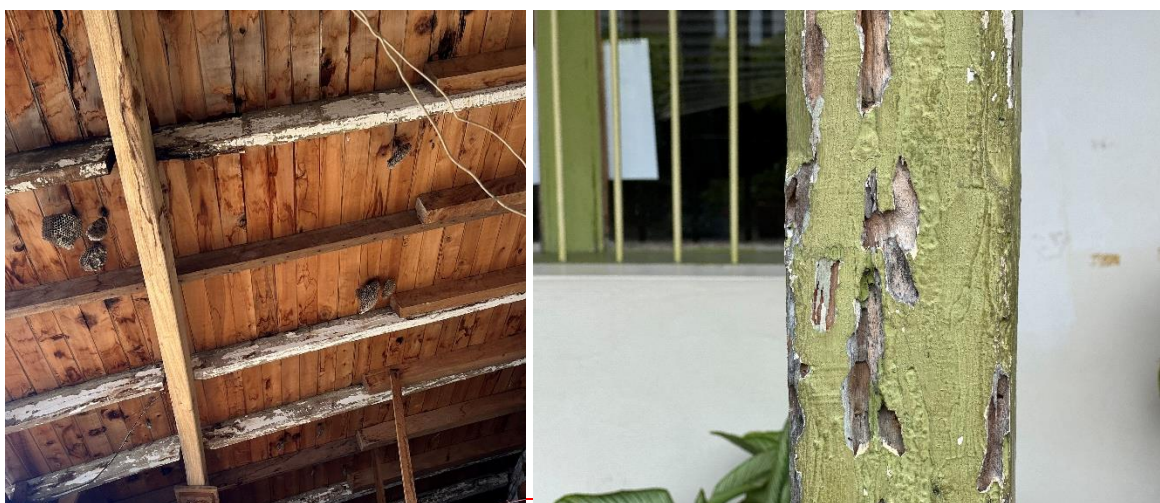
Figura 58 y 59: Presencia de xilófagos en varios elementos de la estructura de cubierta del patio central como vigas, alfardas y tablilla en madera
