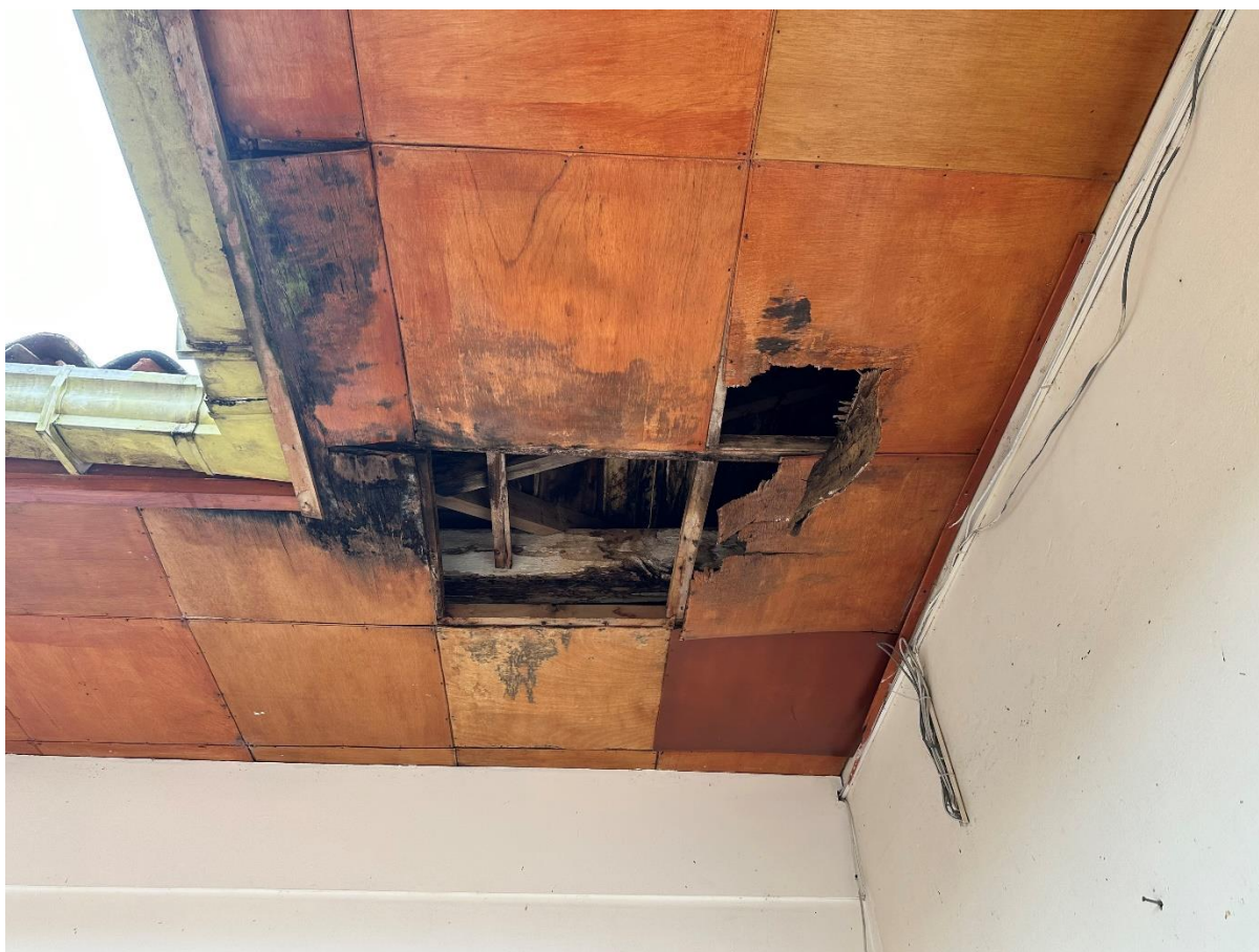
Figura 47: Desprendimiento de cielo falso en la cubierta del corredor interno del patio central
