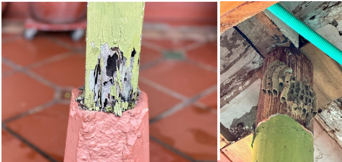
Figuras 60 y 61: Presencia de xilófagos en las columnas de madera de la cubierta del patio central
