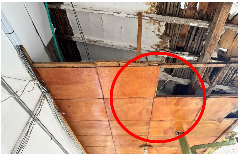
Figura 50: Grietas transversales de varios elementos por secciones (vigas, alfardas y tabillas en la cubierta del corredor patio central
