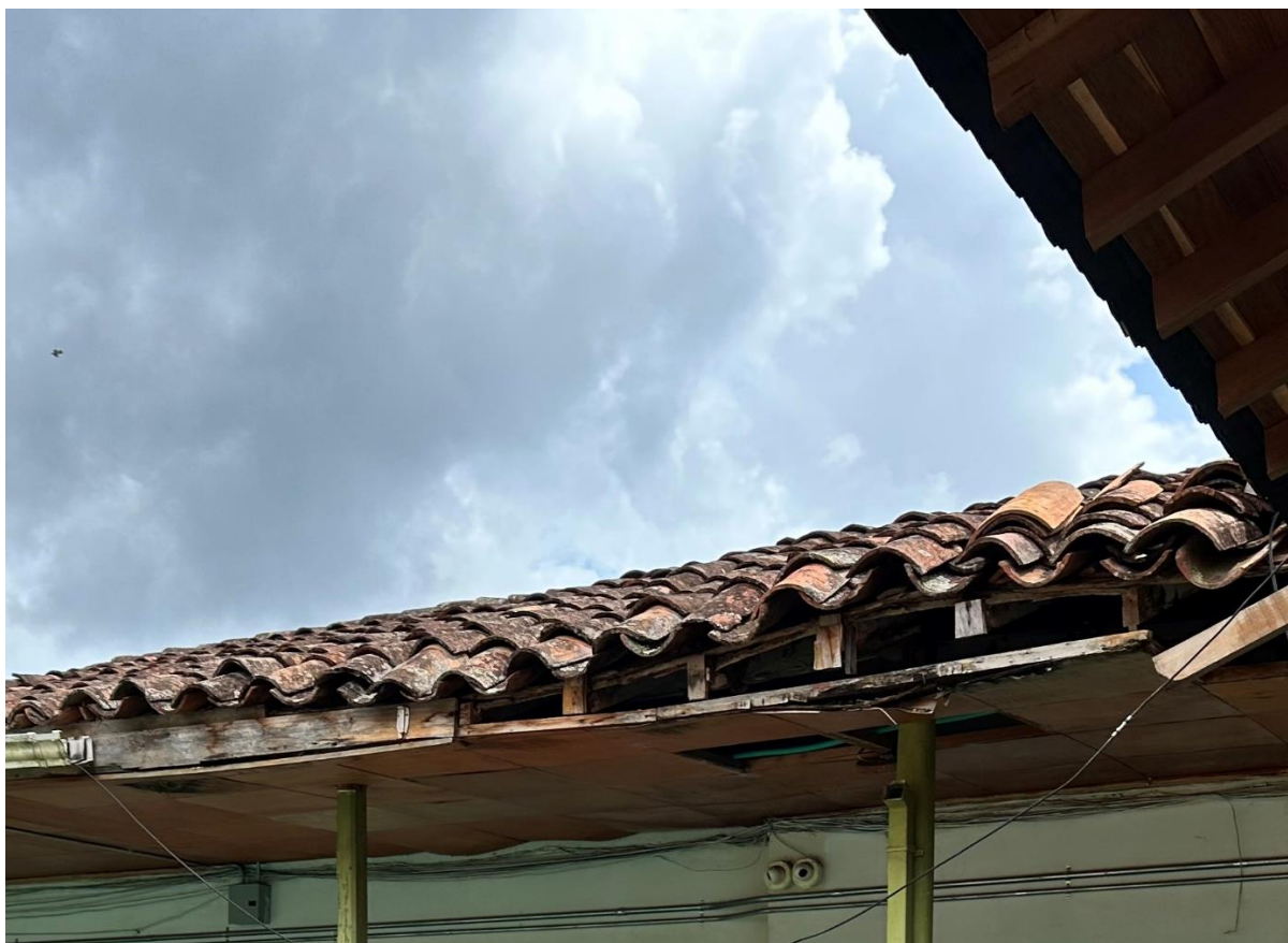
Figura 54: Acumulación de material de naturaleza orgánica en la superficie de la cubierta
