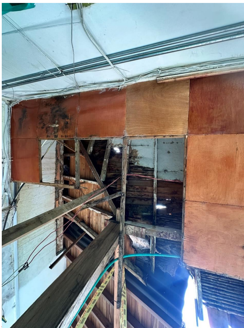
Figura 46: Desprendimiento de elementos por secciones de la cubierta del corredor interno del patio central
