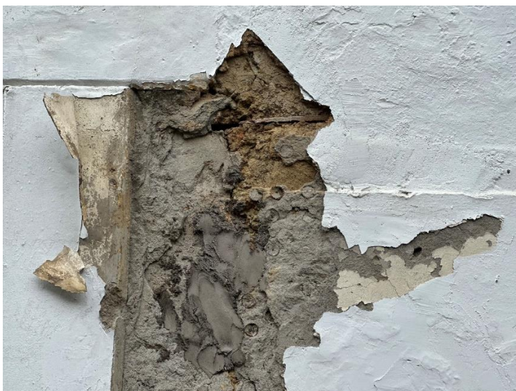
Figura 34: Detalle afectación en muro tapia de fachada.
