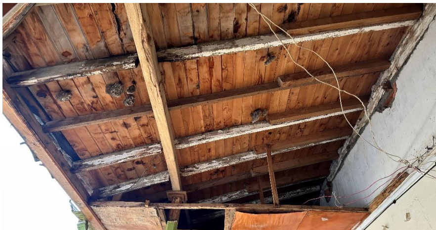
Figura 52: Filtraciones de agua lluvia desde la cubierta de la Secretaría de Hacienda
