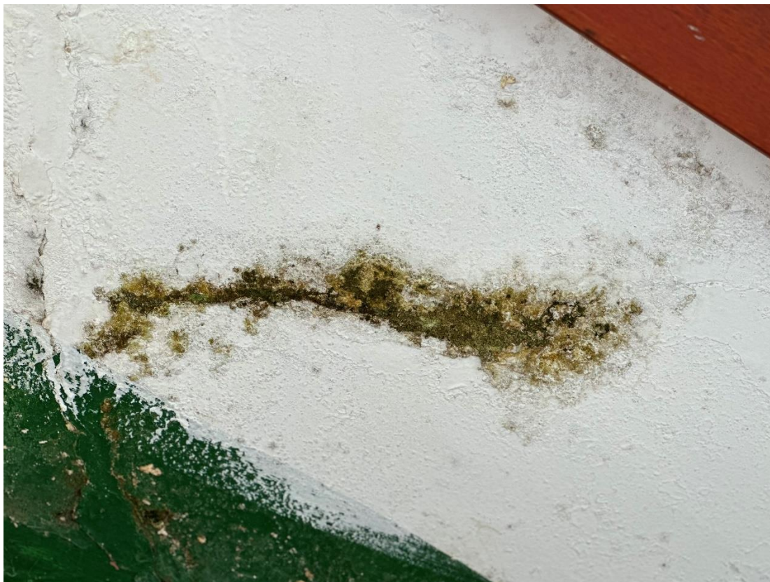
Figura 56: Manchas con presencia de líquenes, musgos y hongos o fungi en las escaleras de ingreso al inmueble por el nivel por la calle 29
