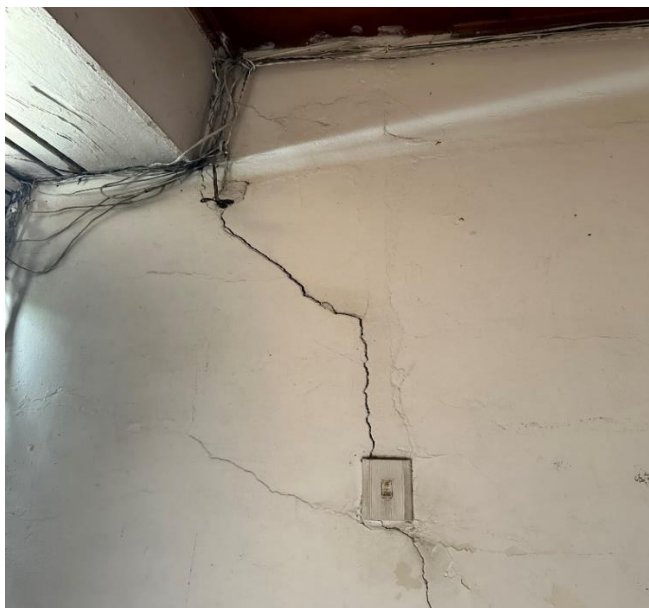
Figura 33: Detalle fisuramiento transversal en muros
