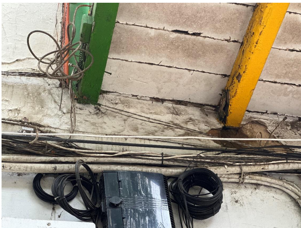
Figura 53: Manchas de chorreo a elementos de fachada por material particulado y acumulación de vegetación epifita
