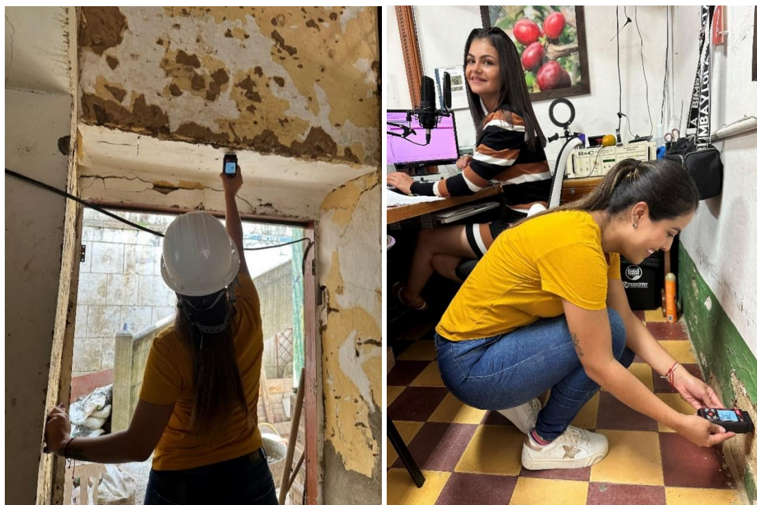
Figuras 92, 93, 94, 95, 96 y 97: Registro Fotográfico Lecturas Higrométricas – Tapia Pisada – Muro Fachada sobre la Carrera 30
