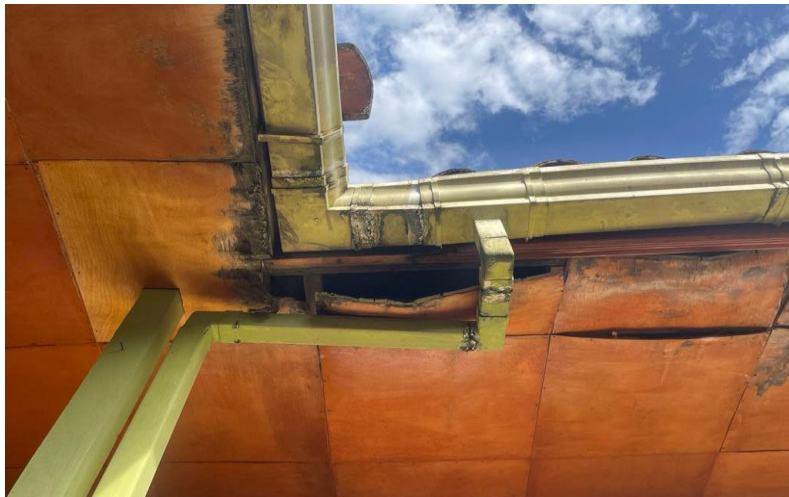
Figura 38: Detalle humedad cubierta y deficiente sistema de recolección de aguas lluvias
