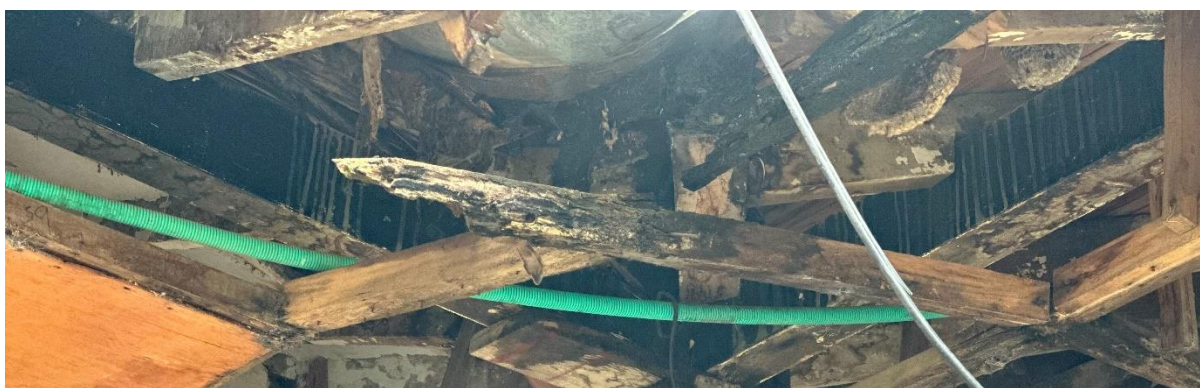
Figura 62: Presencia de líquenes, musgos y epifitas en varios elementos de la estructura de cubierta del patio central (vigas, alfardas y tablilla en madera)
