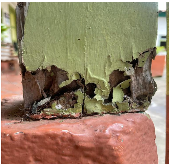
Figura 37: Detalle afectación de columna en madera por insectos
