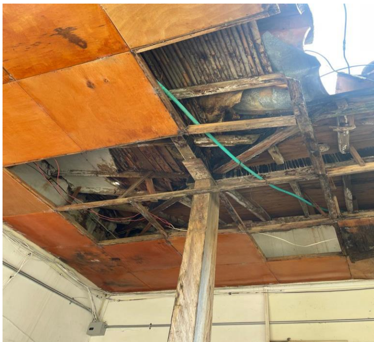
Figura 35: Detalle afectación por flexión y desprendimiento estructura cubierta en madera.
