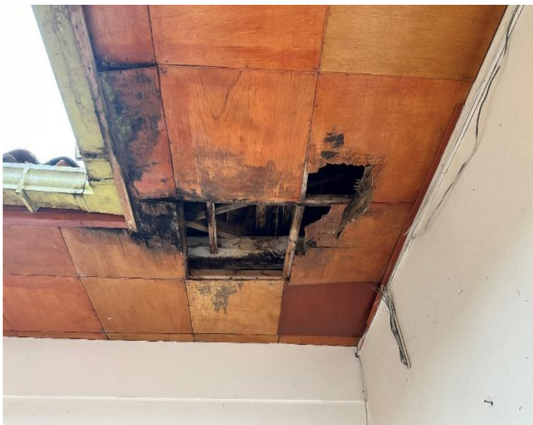
Figura 39: Detalle desprendimiento parcial de cielo falso en madera
