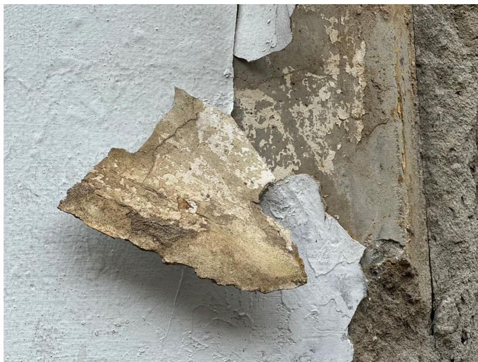
Figura 51: Descascaramiento y pérdida del recubrimiento del acabado de la mampostería externa sobre la carrera 30
