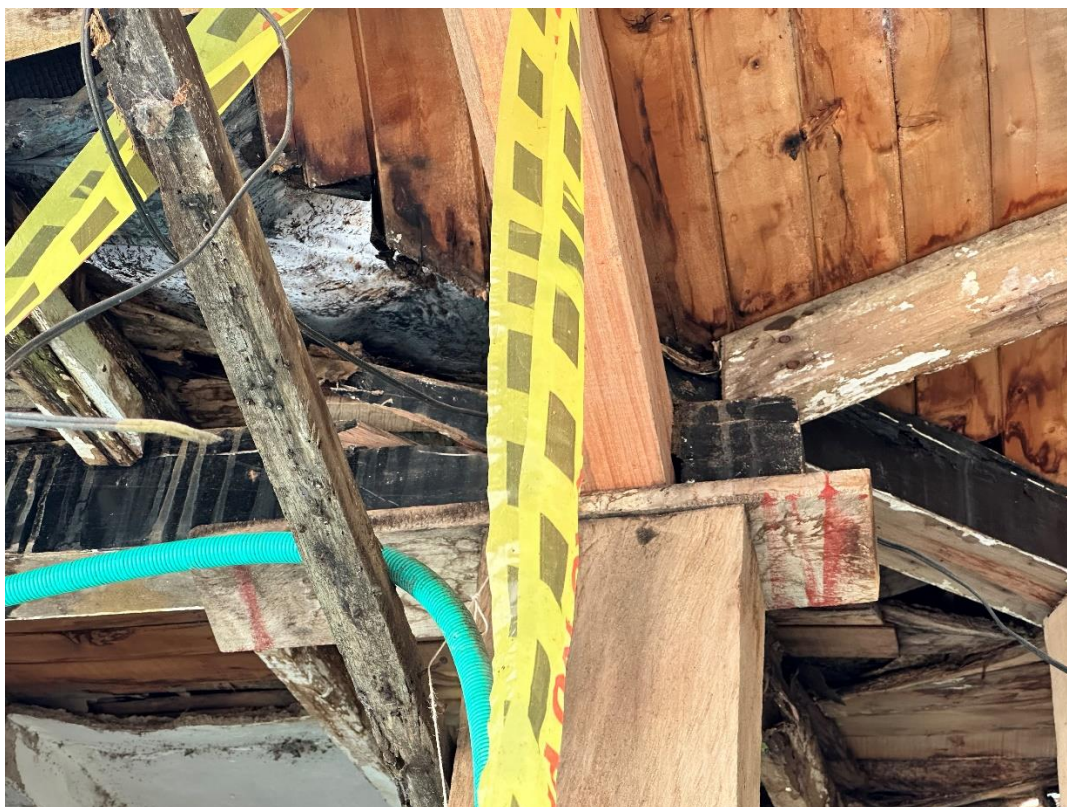
Figura 48: Deformaciones de la estructura de la cubierta en madera del corredor interno del patio central
