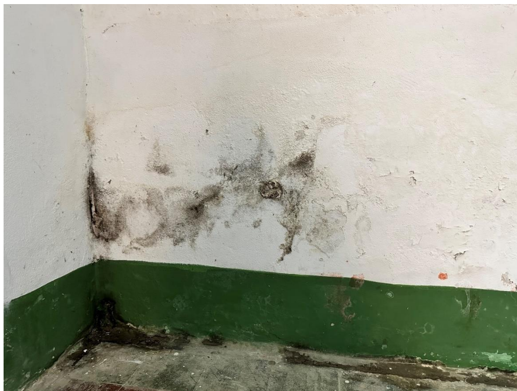
Figura 32: Detalle eflorescencia en mampostería
