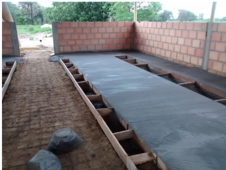
Figura 25. Establecimiento del sistema de fosa húmeda gestación. (QUALITY PORK S.A.S, 2018).
