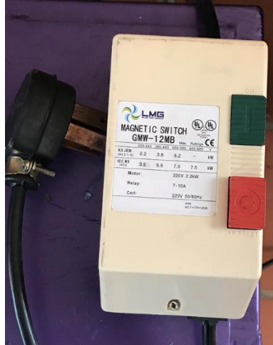
imagen 11. Control de encendido/apagado instalado
