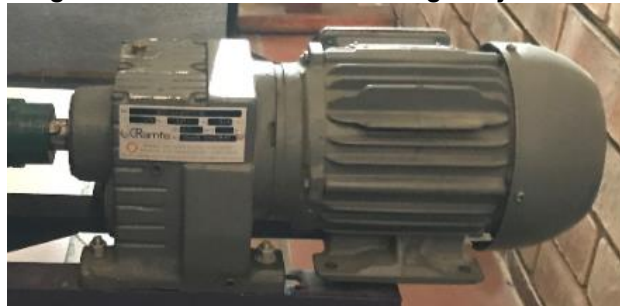
imagen 10. Motor-Reductor de engranajes instalado
