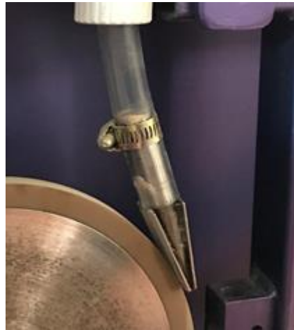
imagen 1. Boquilla dosificadora instalada
