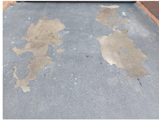
Fotografía 22. Detalle desprendimiento en placa.
