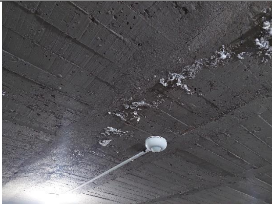
Fotografía 33. Detalle de filtraciones en junta placa superior de sótano.
