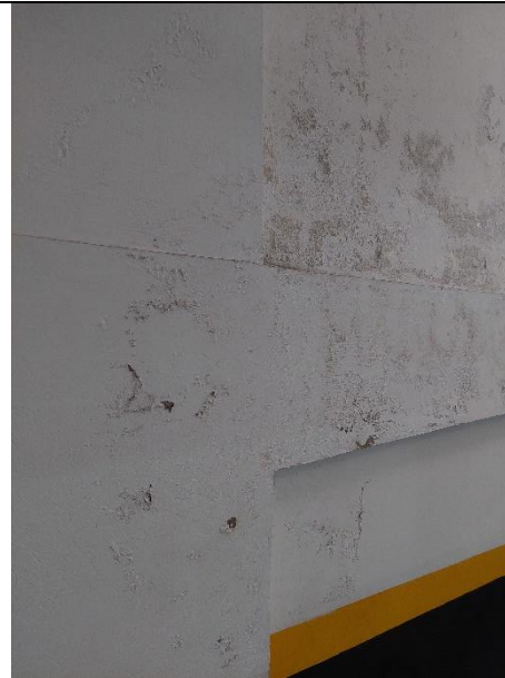
Fotografía 38. Detalle de humedad en columna y viga.
