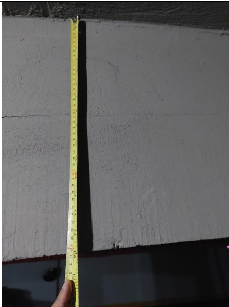
Fotografía 9. Fisura de placa de entrepiso ancho de 0.2mm.
