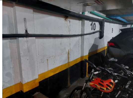
Fotografía 26. Muro entre parqueadero 10 y 11. Área de filtración.
