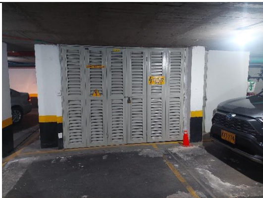
Fotografía 35. Cuarto eléctrico en sótano.
