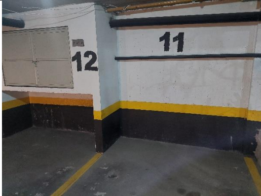
Fotografía 25. Parquedero 11 y 12. Área filtración.
