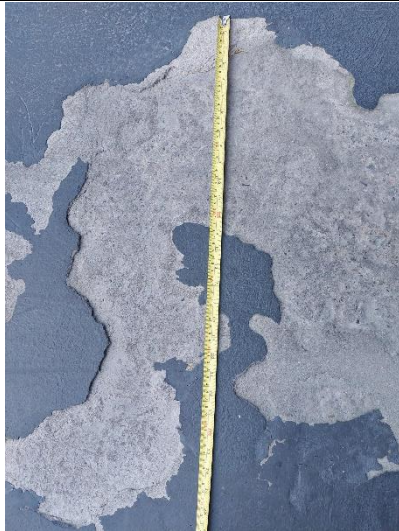
Fotografía 23. Longitud de la lesion huella izquierda de 2,0m.
