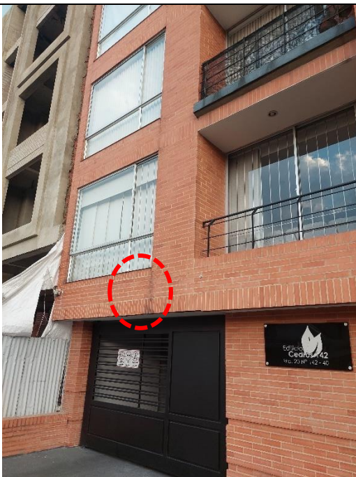
Fotografía 5. Detalle mancha en esquina de alfajía.
