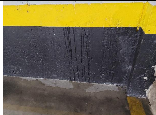
Fotografía 28. Detalle de filtraciones a través de muro de contención. (16 septiembre 2023).
