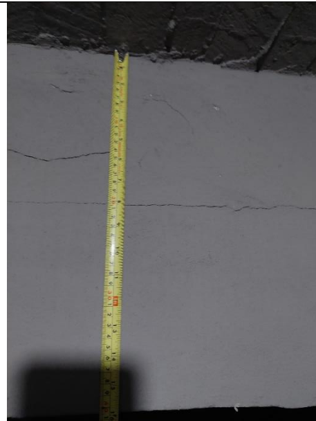
Fotografía 10. Medición de distancia entre fisuras de placa de entrepiso.
