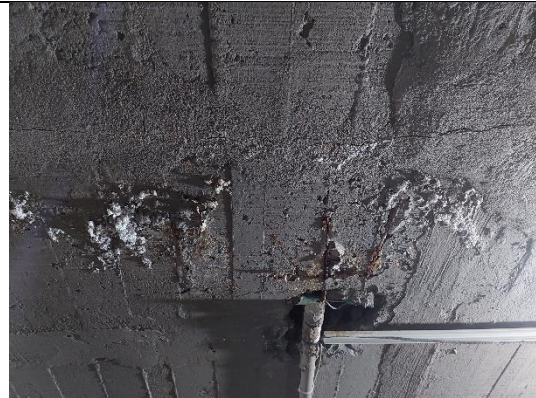
Fotografía 34. Detalle de zona de filtraciones en placa.
