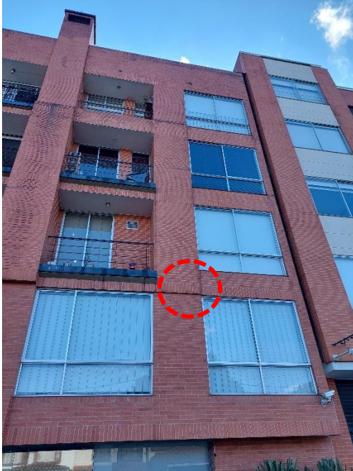
Fotografía 3. Detalle de manchas en esquina de ventanas y parte superior de la fachada.
