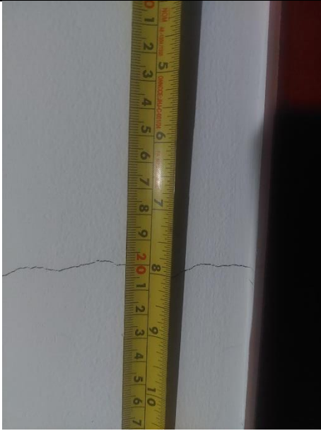
Fotografía 45. Medición de fisuras transversales en muro divisorio ancho 0.2 mm.
