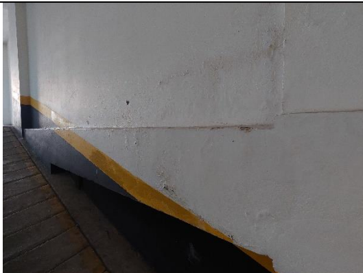
Fotografía 39. Muro perimetral afectado con humedad.
