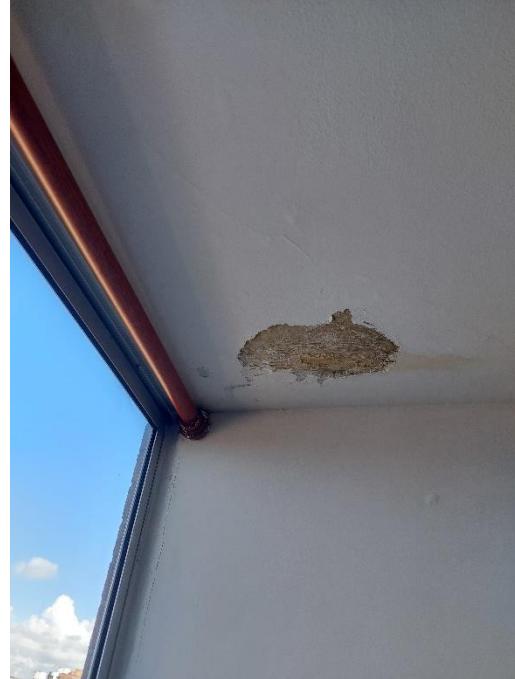
Fotografía 4. Afectación de humedad al interior de la unidad de vivienda 502. Lesión Secundaria
