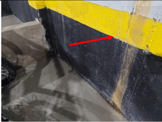
Fotografía 31. Seguimiento a filtraciones a través del muro de contención. (04 octubre 2023).
