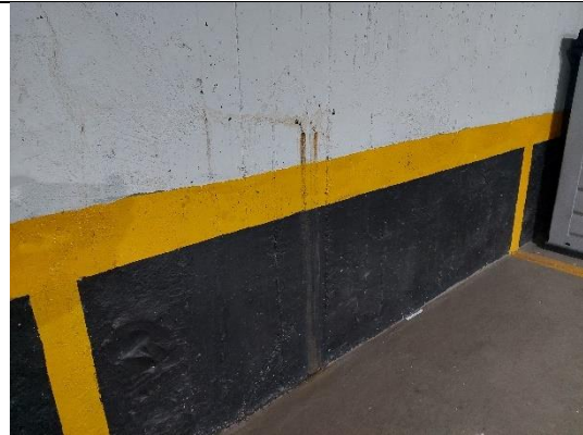
Fotografía 30. Seguimiento a filtraciones a través del muro de contención (04 octubre 2023).
