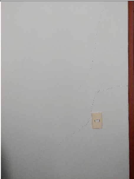
Fotografía 43. Detalle de fisura transversal.
