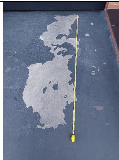
Fotografía 24. Longitud de la lesion huella derecha de 2,5m.
