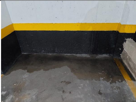
Fotografía 27. Muro costado occidental. Detalle empozamiento. (16 septiembre 2023).
