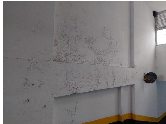
Fotografía 40. Continuidad de humedad en elementos estructurales y no estructurales.
