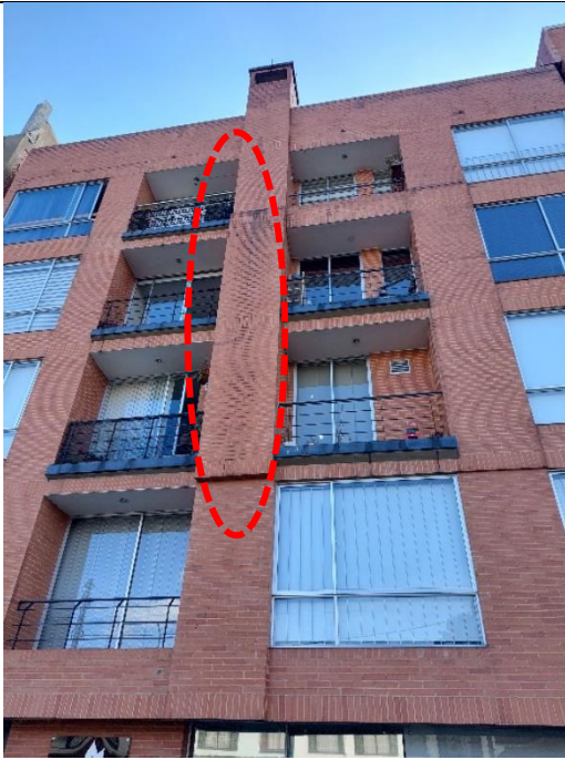
Fotografía 1. Detalle mancha central en fachada.
