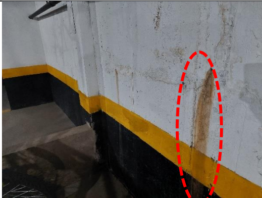
Fotografía 29. Filtración y marcas por escurrimiento.
