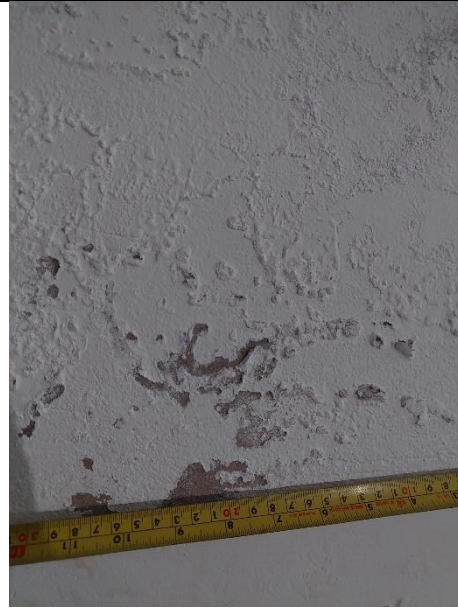
Fotografía 42. Medición de seguimiento a los desprendimientos de pintura y pañete.
