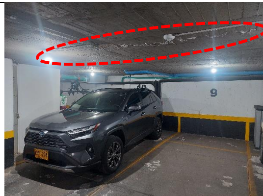
Fotografía 36. Parqueadero 9 y 10 – Detalle de infiltración placa superior (Eflorescencias).
