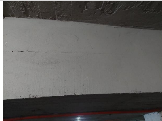
Fotografía 8. Detalle continuidad de la fisura en placa.
