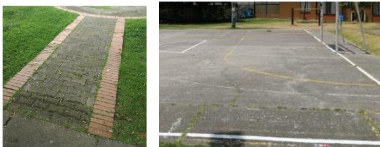
Figura 89. Estado De Pavimento UE
