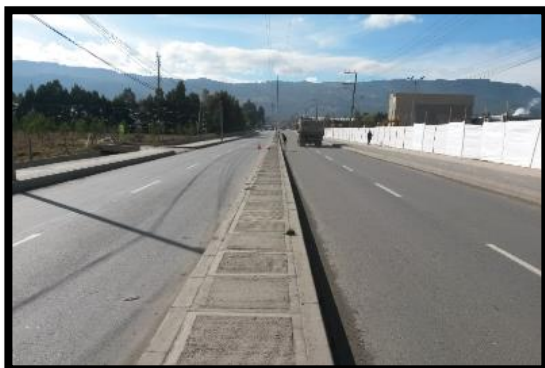
Fotografía 10. Separador autódromo, ANTES.
