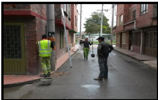
Fotografía 16. Instalación SR-28, ANTES.
