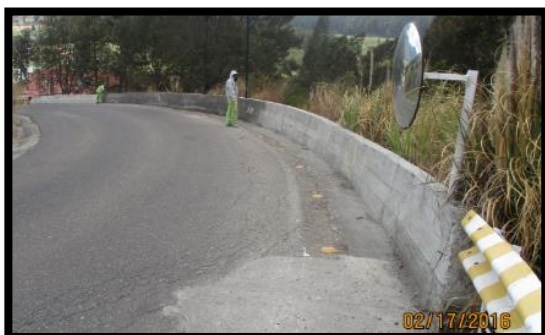
Fotografía 24. Muros de contención, ANTES.
