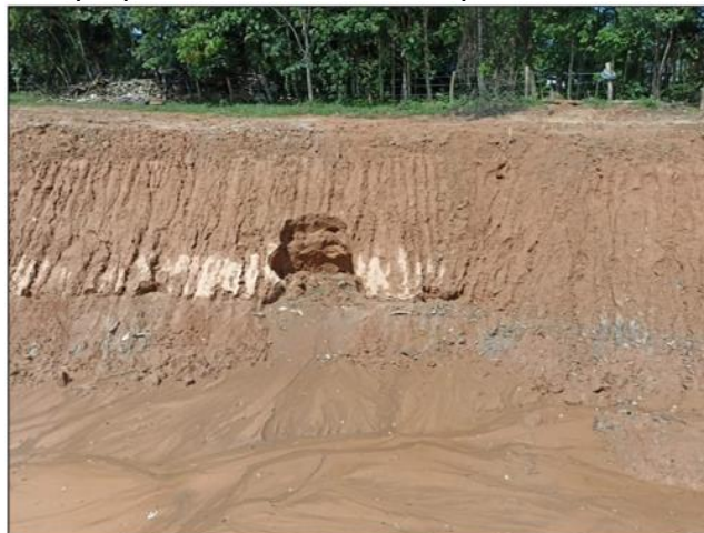
Figura 4. Efecto del agua superficial en los taludes conformados
