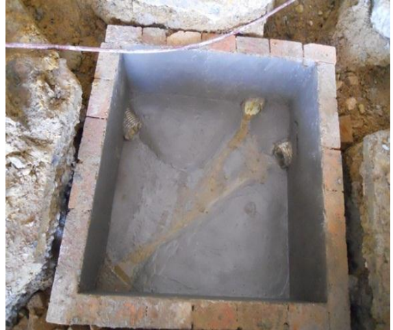
Fotografía 26. Caja de inspección de 1.20m x 1.20m
