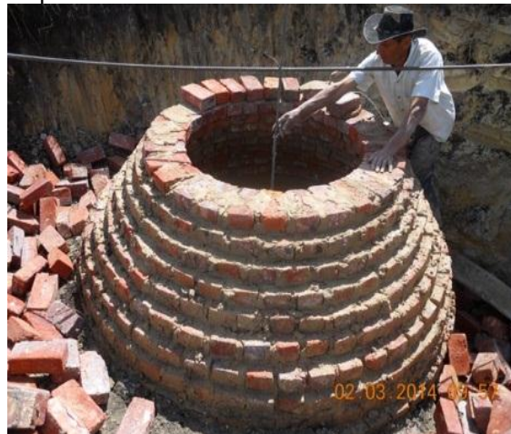
Fotografía 19. Reducción cónica pozo de inspección:
