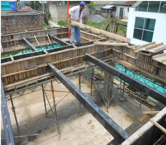
Fotografía 9. Perfiles metálicos 20x12
