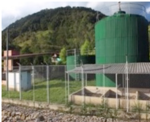
Fotografía 63. PTAR de Arcabuco-Boyacá.
