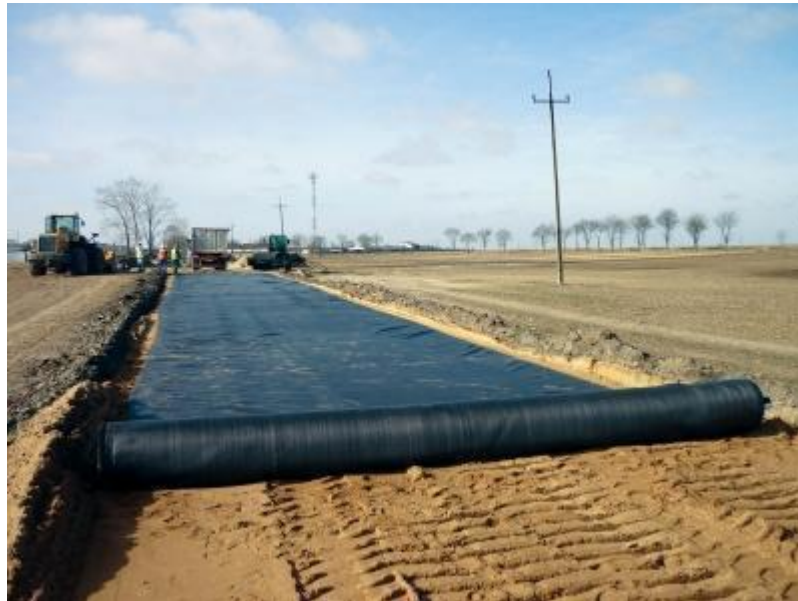
Figura 10. Puesta en obra para aplicación de geotextiles. Geotexan. (2013). El uso de geosintéticos en las vías de acceso a parques eólicos. [Comercial]. Geotexan . https://geotexan.com/el-uso-de-geosinteticos-en-las-vias-de-acceso-a-parques-eolicos/
