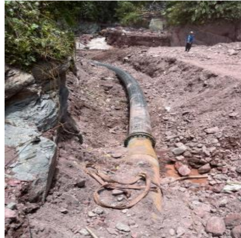
Fotografía 7: Estado de tubería instalada
