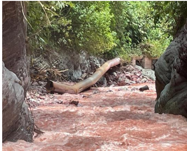
Fotografía 12: Estado de tubería CCP durante la inspección.
