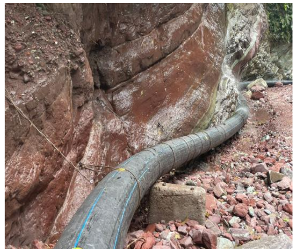
Fotografía 14: Estado de la tubería faltante
