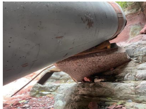
Fotografía 11: Estado de la tubería CCP como se encuentra actualmente..
