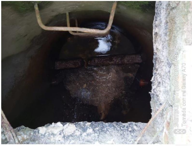
Ilustración 2. Captación de agua tipo galería de filtración, Vereda San Isidro
