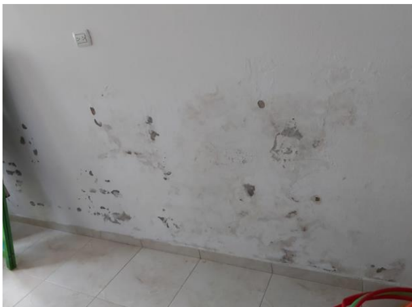
Ilustración 20. Pared con presencia de humedad
