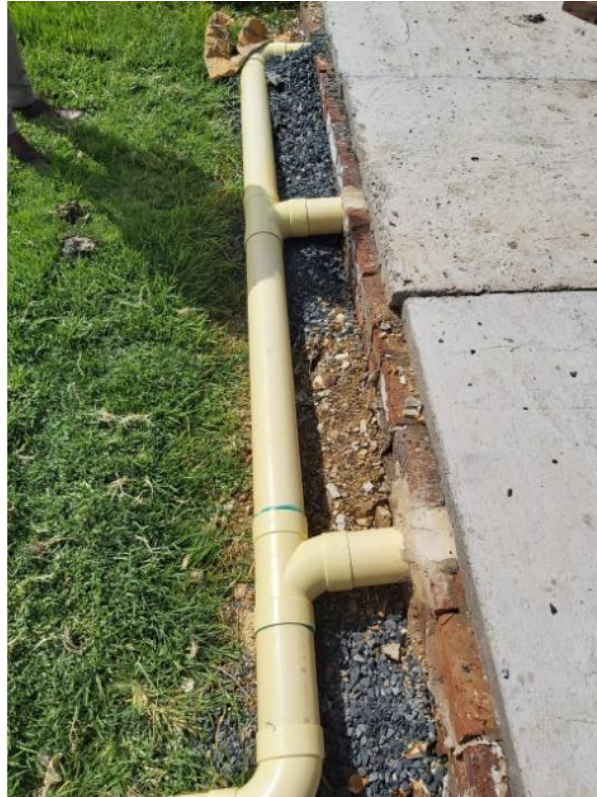
Ilustración 10. Tubería de Salida pozos sépticos
