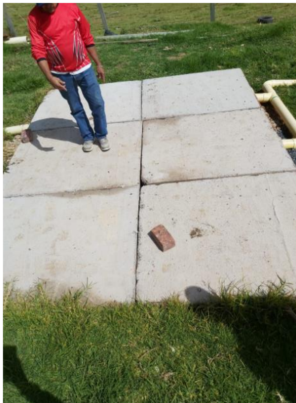
Ilustración 11. Tapas de Inspección pozos sépticos
