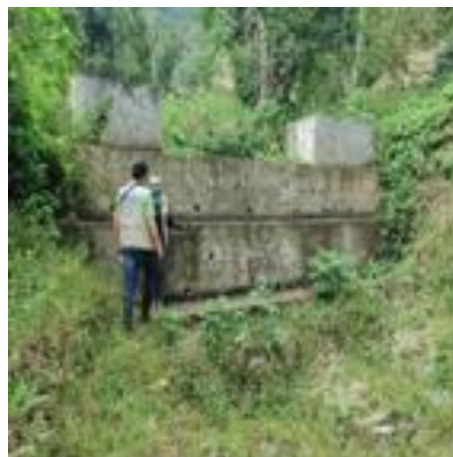
Figura 12. Visita Municipio Santa María Convenio 027-15. Pérdida de la solidez de la estructura y desprendimiento de concreto
