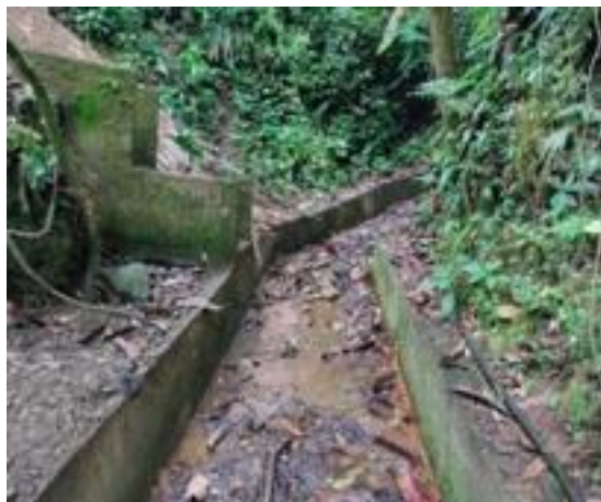
Figura 6. Visita Técnica Municipio de Santa María Convenio 019-16. Acumulación de material en la sección del Canal.
