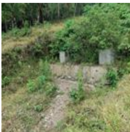
Figura 13. Visita Municipio Santa María Convenio 027-15. Crecimiento de vegetación por falta de mantenimiento.
