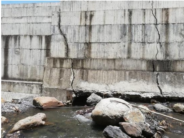
Figura 22. Visita Municipio La Capilla Convenio 024-18. Fallas Estructurales Muro de Contención
