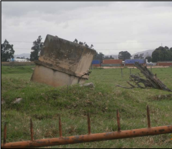
Asentamiento de Tanque de Agua por problemas de desecación en la zona de estudio.
