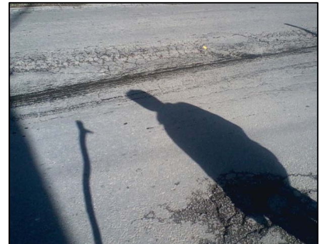
Piel de cocodrilo y grietas longitudinales presentadas a lo largo del ancho de la vía de estudio
