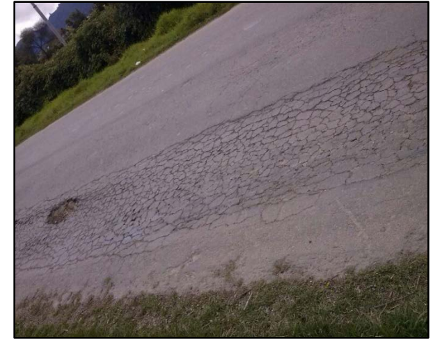
Fin de vida útil, junto a grietas longitudinales al borde de la vía de estudio
