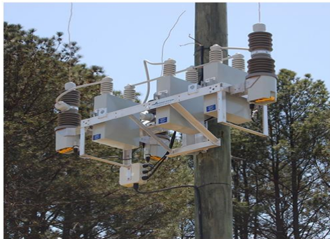
Figura 49. Ilustración postes con banco de condensadores
