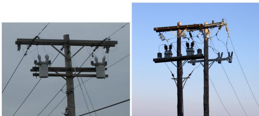
Figura 47. Ilustración postes con maniobra eléctrica reconectador
