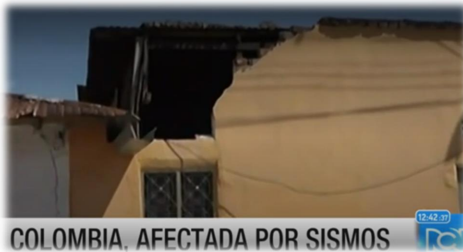
Imagen 38 Daños ocasionados en elementos no estructurales de vivienda, el sismo del 30 de octubre de 2016 en Huila Colombia.
