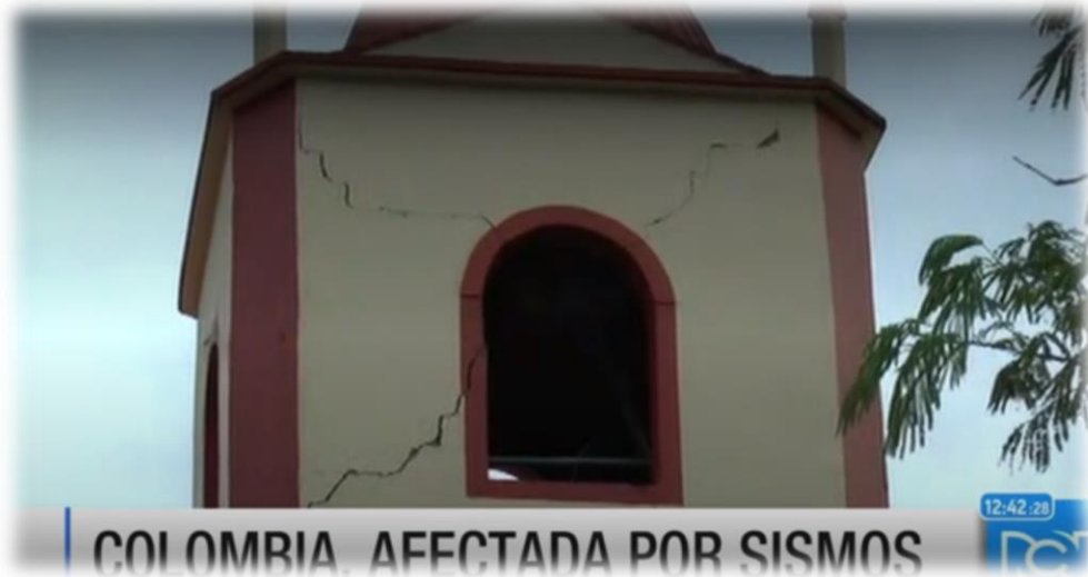
Imagen 37 Daños ocasionados en Iglesia por el sismo del 30 de octubre de 2016 en Huila Colombia
