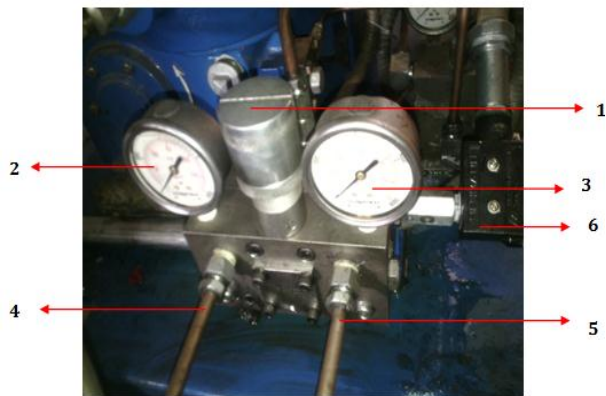
Imagen 4. Válvula inversora VCIR-40. Fuente: Autor, Barrios A, María Camila, Visita estación central de bombeo tren dos, año 2015
