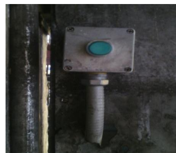
Imagen 14. Pulsador marcha/parada. Fuente: Autor, Barrios A, María Camila, estación central de bombeo, 2015.
