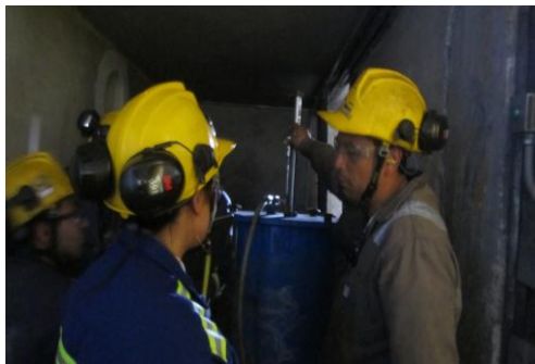
Imagen 18. Pruebas sensor de Nivel. Fuente: Autor, Barrios A, María Camila, Estación central de bombeo tren continuo tren dos, 2015
