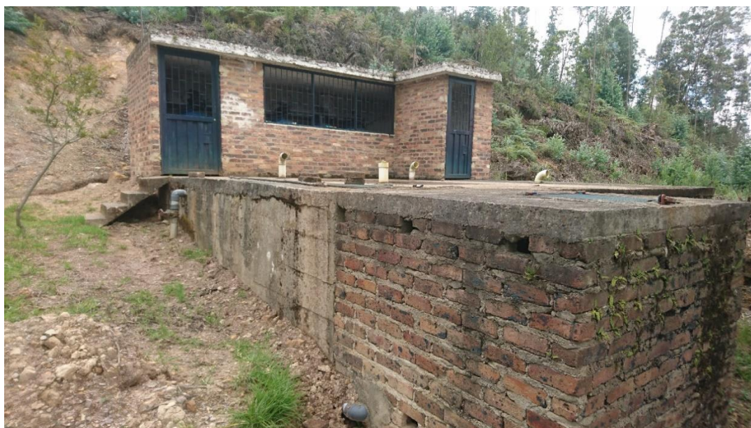
Imagen 4 Tanque de almacenamiento acueducto ACUAVARC
