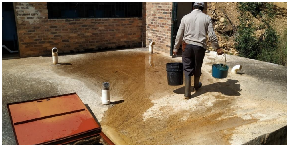
Imagen 8 Aplicación de desinfectante al agua filtrada
