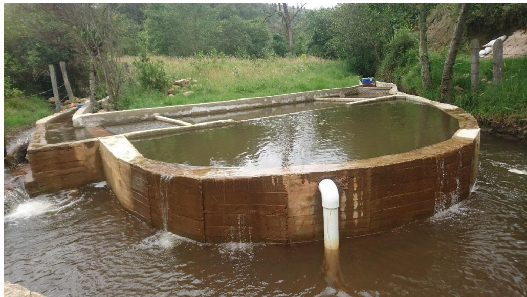
Imagen 2 Bocatoma de fondo, cámaras de sedimentación para cada quebrada
