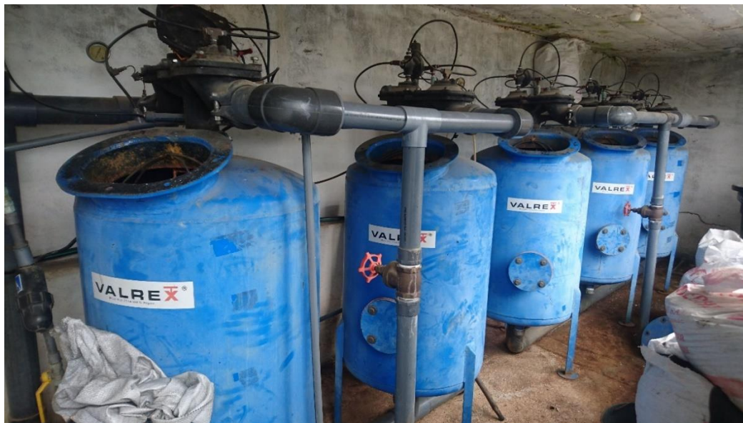
Imagen 3 Planta de tratamiento acueducto ACUAVARC
