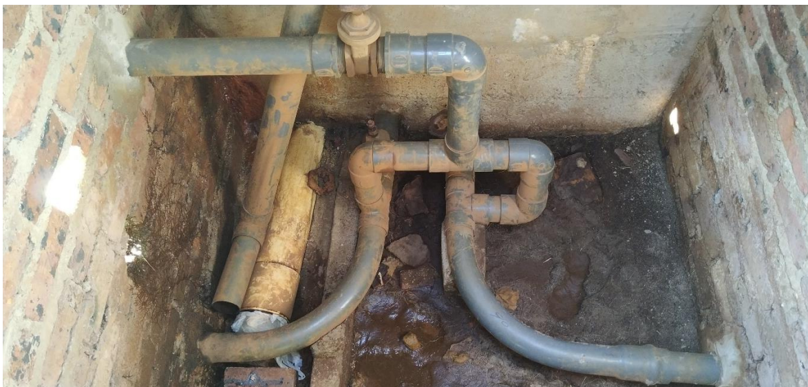
Imagen 11 Pieza de registros, inicio de la red de distribución
