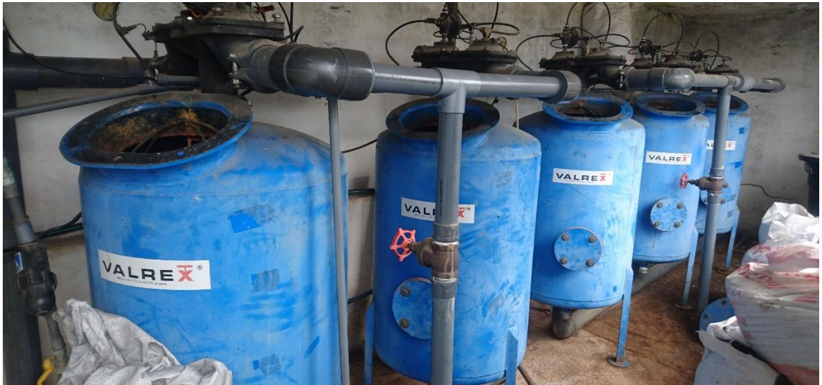
Imagen 9 Planta de tratamiento, tanques de filtración
