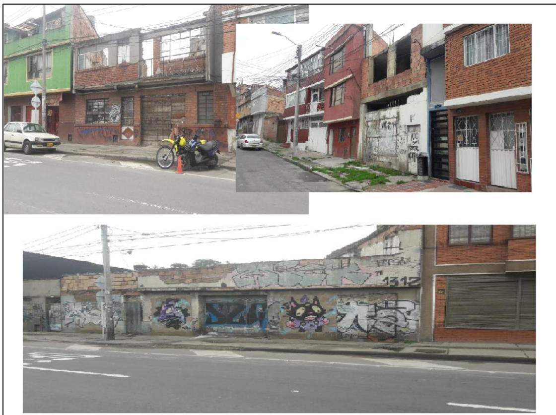
Fotografía 8: Casas abandonadas y deterioradas. Barrio Inglés
