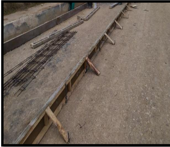
Fotografía 37 Formaleta Antes de la Patología Fuente: Autor
