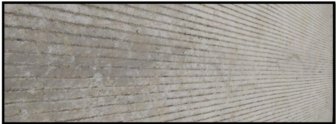
Fotografía 45 Fisuras sin Descascamiento de Concreto Fuente: Autor
