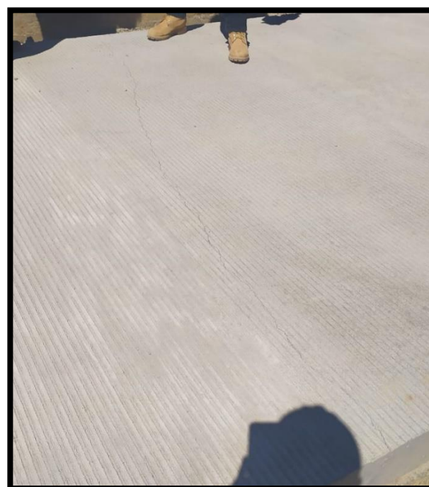
Fotografía 29 Grieta transversal de losa Fuente: Autor
