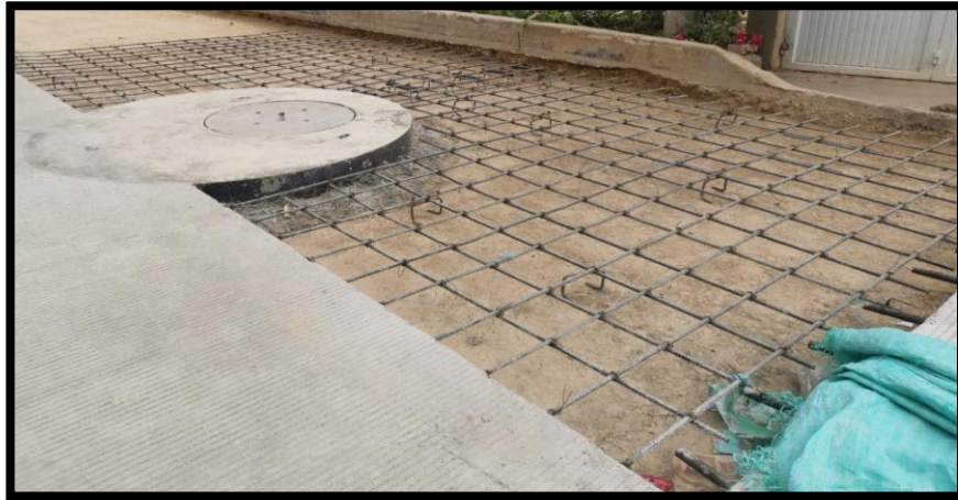
Fotografía 22 Losa irregular de Pozo de inspección Reforzada Fuente: Autor
