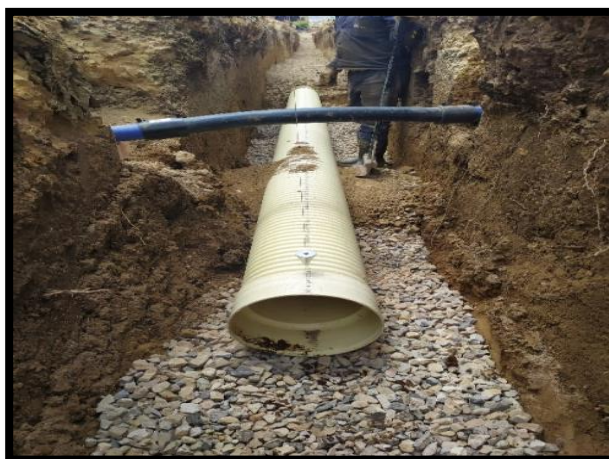
Fotografía 5 Colector Principal Fuente: Autor
