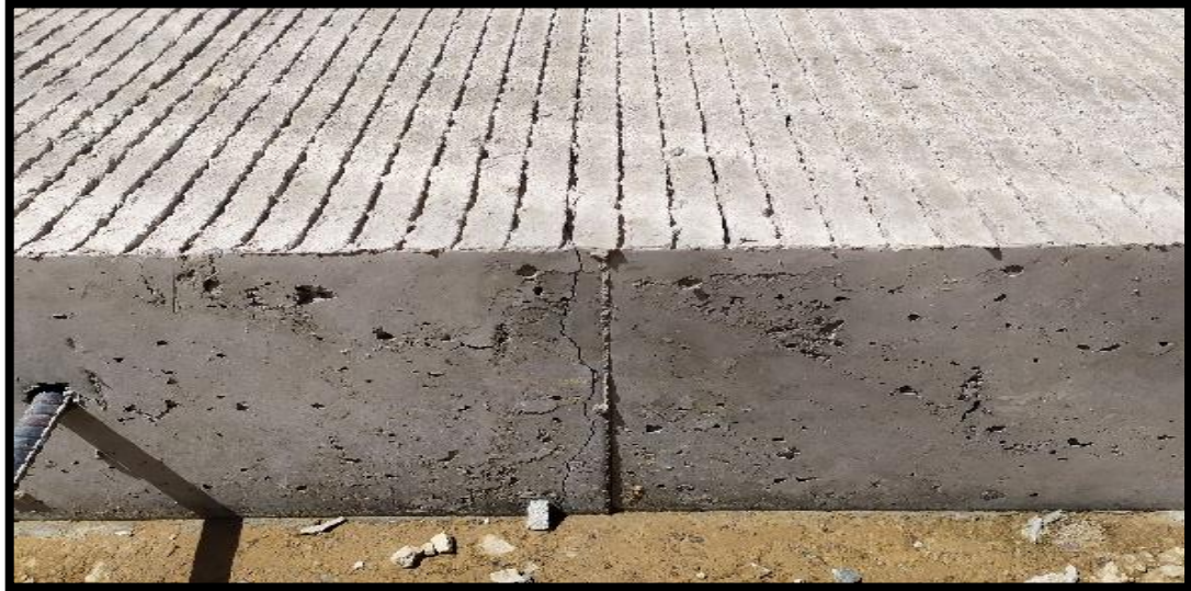
Fotografía 30 Vista perfil Grieta transversal, espesor de losa Fuente: Autor
