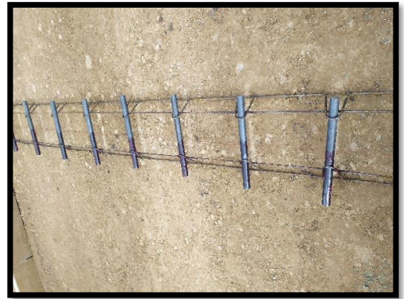
Fotografía 21 Canastilla en Obra. Fuente: Autor
