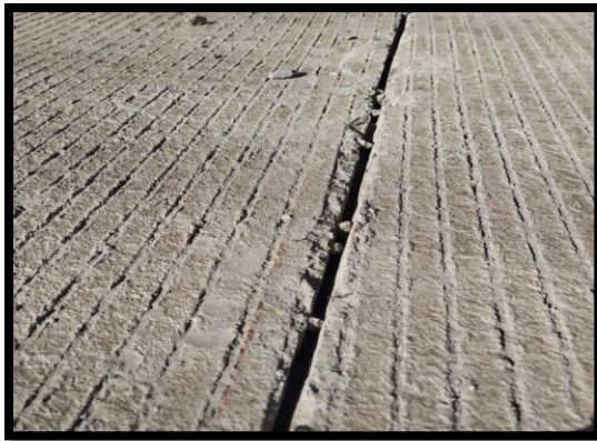
Fotografía 40 Desportillamiento de Losa Fuente: Autor
