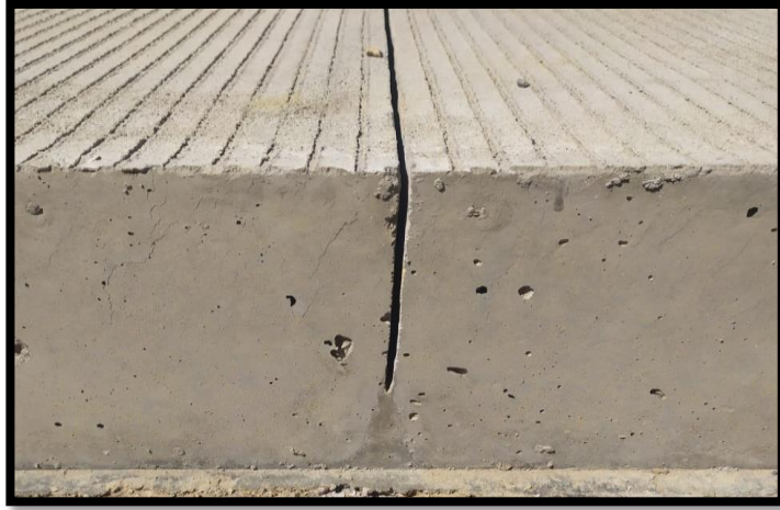
Fotografía 33 Sin control de fisura, ocasionando la grieta en la losa. Fuente: Autor
