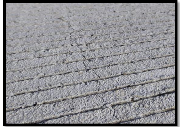
Fotografía 44 Vista en Planta de Fisura Fuente: Autor
