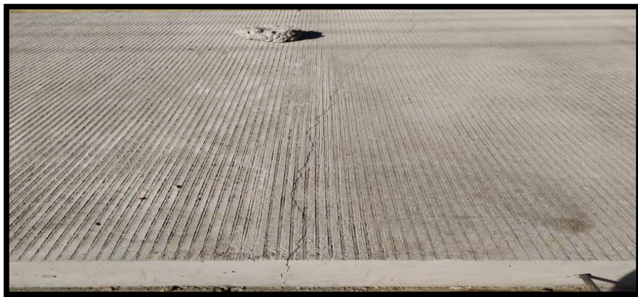
Fotografía 32 Vista en Planta, Longitud de la Grieta. Fuente: Autor
