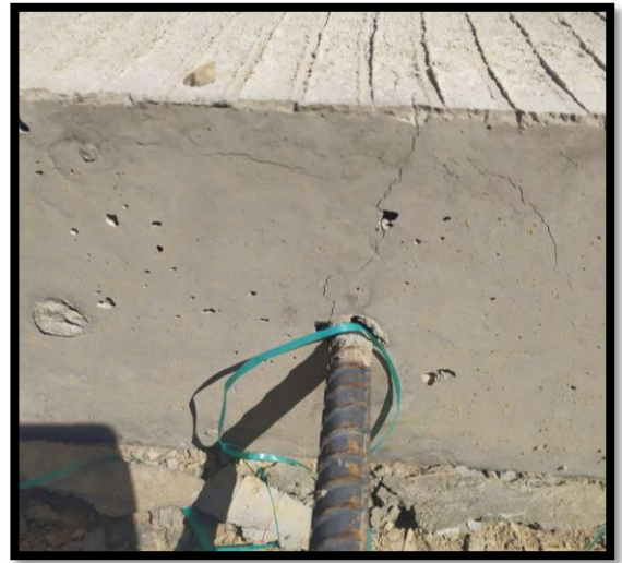
Fotografía 36 Fisura cerca a la Barra de Amarre Fuente: Autor
