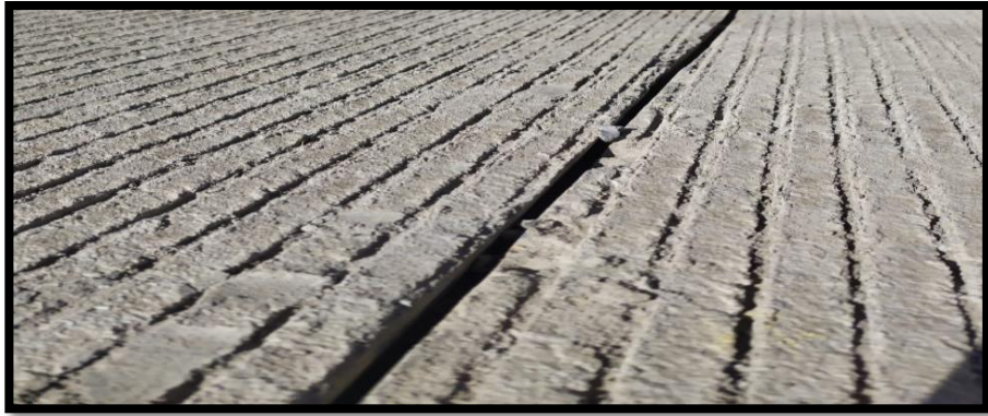
Fotografía 42 Daño de Desportillamiento de la Losa Fuente: Autor
