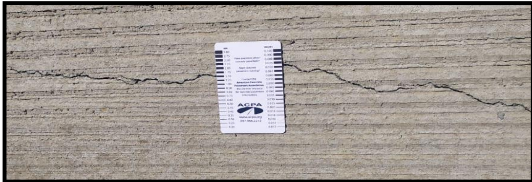
Fotografía 31 Vista en Planta, abertura de la Grieta transversal. Fuente: Autor
