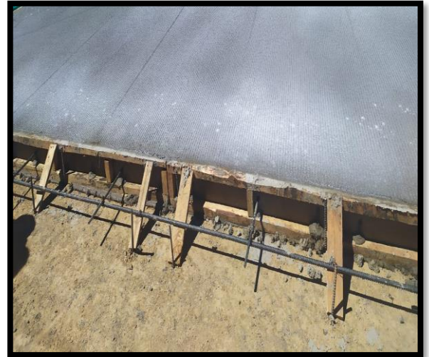
Fotografía 38 Formaleta Después de la Patología. Fuente: Autor
