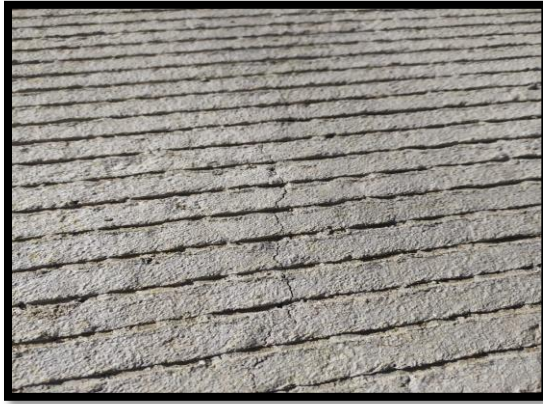
Fotografía 43 Pequeñas Fisuras en Losa de Concreto Fuente: Autor
