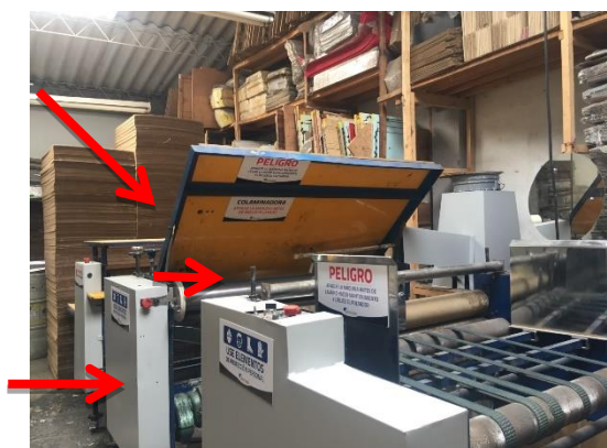
Figura 22: Señalización en máquinas
