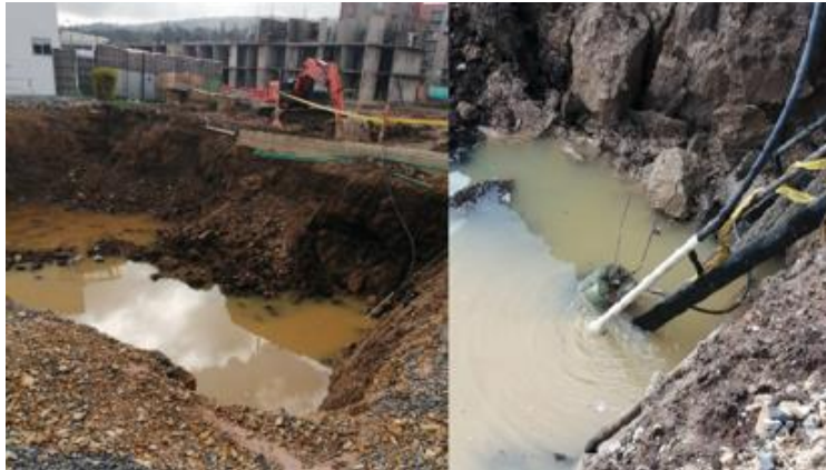
Figura 6. Presencia de agua en la excavación de la etapa 1 y bombeo del agua
