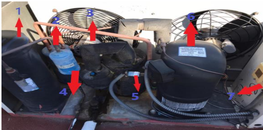
Figura 2. Equipo de refrigeración, Varios 1.
