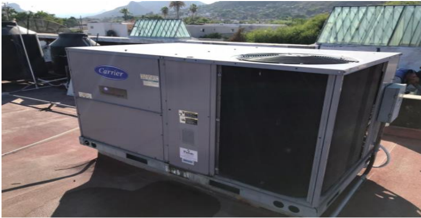
Figura 6. Equipo central de aire acondicionado, 5 toneladas.
