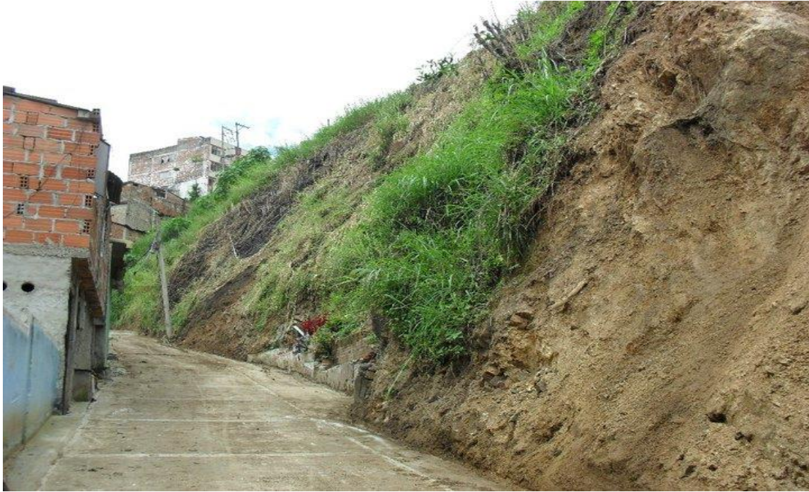
Figura 25. Fotografía sobre el costado oriental. Carrera 51, en la que se evidencian deslizamientos del terreno.
