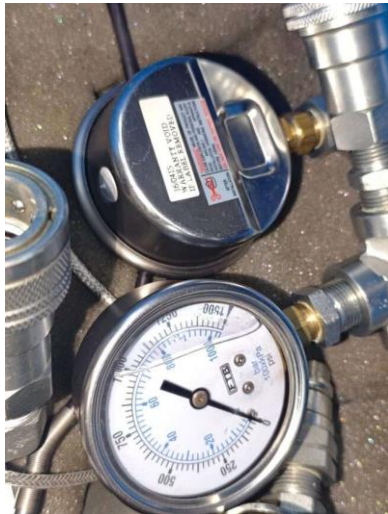
Figura D.7 — SOP-07: manómetro de línea verificado en 0 bar tras el apagado.
