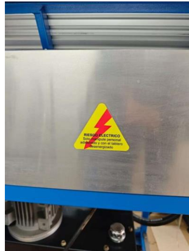
Figura D.8 — SOP-08: señalización de riesgo y mando de apagado de la unidad de potencia.
