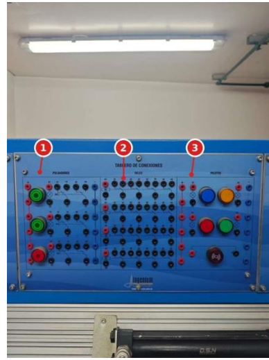
Figura D.6 — SOP-06: tablero de conexiones eléctricas utilizado en la operación de las prácticas.
