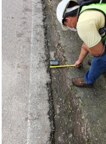
Figura 12.14 Separación de Berma (SB), P203; Sev. A; K0+609.23 Fuente: [22]
