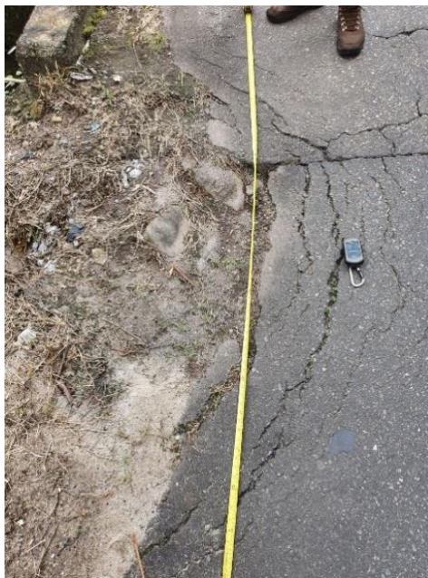
Figura 12.11 Hundimiento (HUN), P543; Sev. A; K1+590.66 Fuente: [22]
