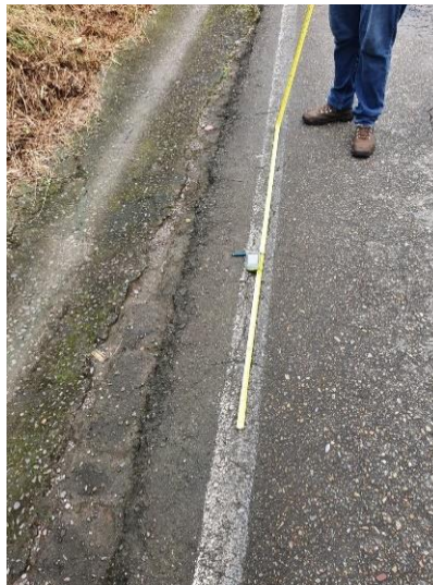
Figura 12.6 Fisura de Borde (FBD), P114; Sev. B; K0+377.71 Fuente: [22]
