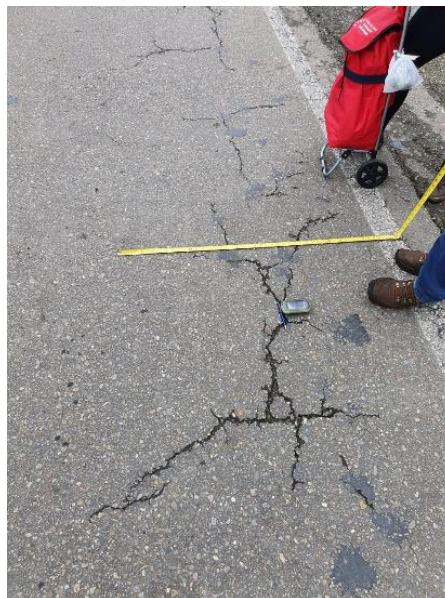
Figura 12.1 Fisura en Bloque (FB), T15; Sev. A; K0+405.21 Fuente: [22]
