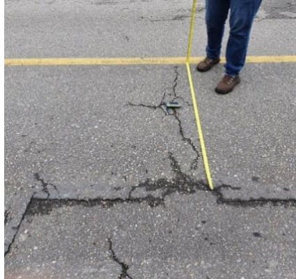
Figura 12.5 Fisura Transversal (FT), P116; Sev. M; K0+380.91 Fuente: [22]
