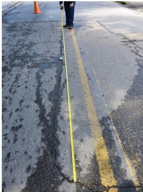
Figura 12.4 Fisura Longitudinal (FL), T1; Sev. A Fuente: [22]
