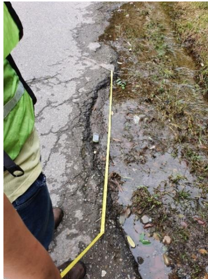
Figura 12.9 Descascaramiento (DC), P194; Sev. A; K0+585.67 Fuente: [22]
