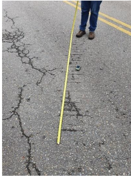
Figura 12.10 Ahuellamiento (AHU), P117; Sev. B; K0+383.01 Fuente: [22]
