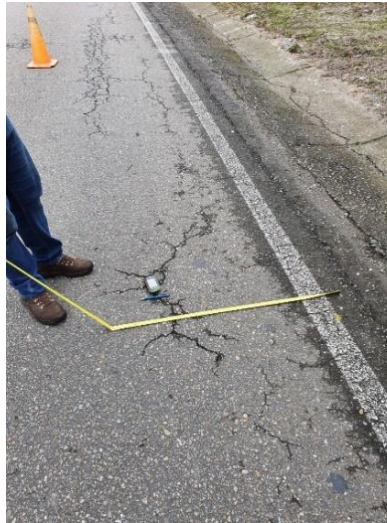
Figura 12.7 Fisura en Media Luna (FML), P131; Sev. M; K0+415.61 Fuente: [22]
