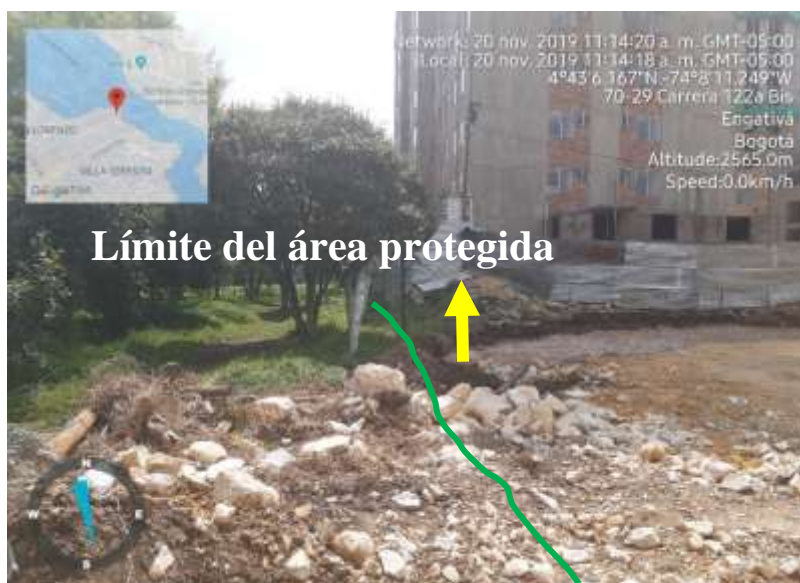
Figura 4. Parque Ecológico Distrital de Humedal Jaboque, localidad de Engativá, Bogotá. Instalación de tubería por constructora dentro de zona de manejo y preservación ambiental, sin autorización ni implementación de medidas de manejo ambiental. Elaboración propia.
