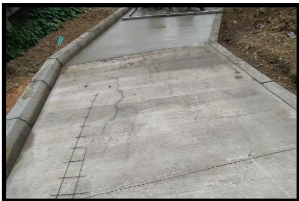
Figura 34. Presencia de grietas en placa fundida.
